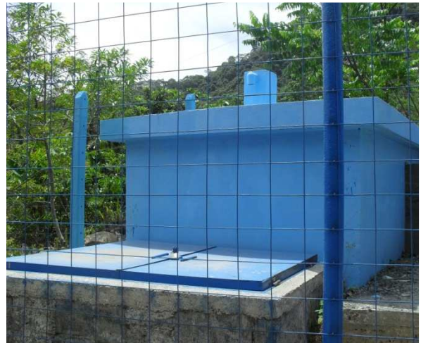
Figura 26. Tanque de almacenamiento
