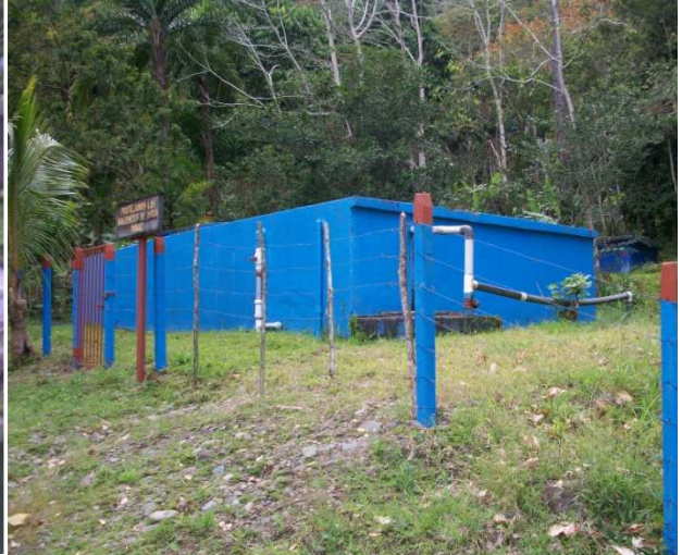
Figura 20. Tanque de almacenamiento
