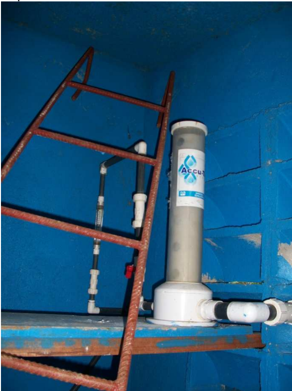
Figura 21. Equipo de cloración hipoclorito de calcio en pastillas
