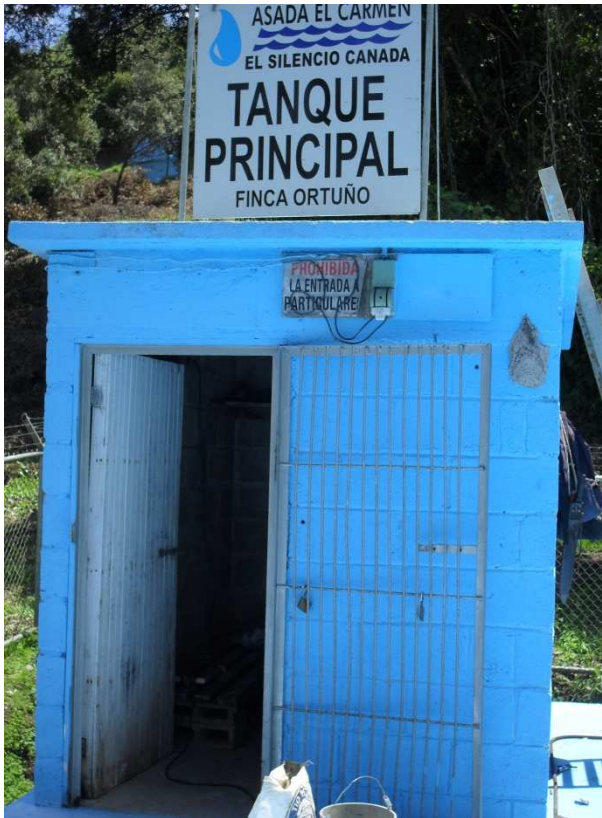
Figura 34. Tanque de almacenamiento, caseta de cloración
