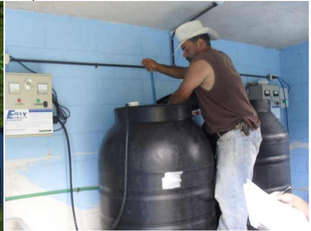
Figura 28. Equipo de producción de cloro a partir de hipoclorito de sodio
