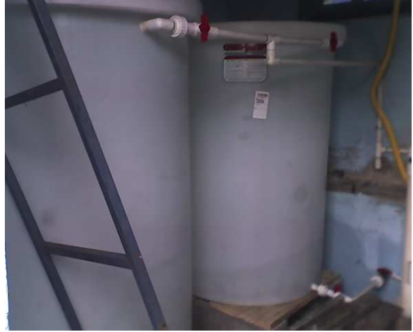
Figura 8. Equipo producción de cloro a partir de hipoclorito de sodio
