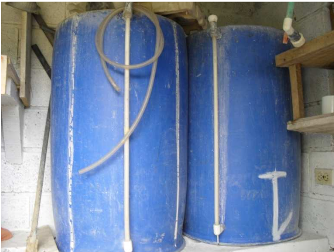
Figura 25. Equipo de cloración (hipoclorito de sodio) sin uso
