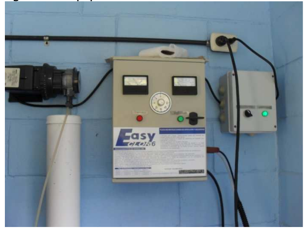
Figura 30. Equipo de cloración
