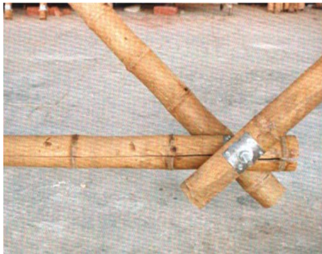
Figura 18: Falla en elementos de bambú por corte paralelo a las fibras.
