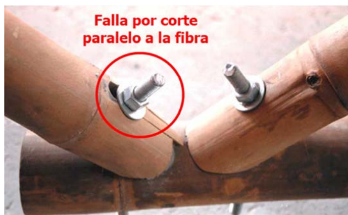
Figura 17: Falla en elementos de bambú por corte paralelo a las fibras.
