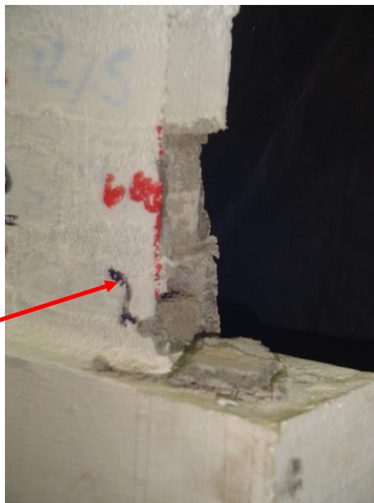
Figura 68. Ampliación de la falla en la zona de compresión del muro integral #2.
