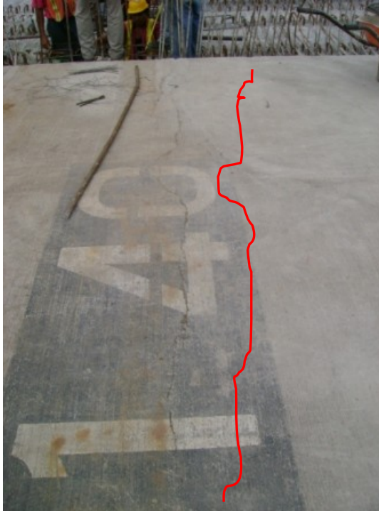
FIGURA 4.7 GRIETA EN LOSA DE MUELLE DE CRUCEROS DEBIDO A COLISIÓN
