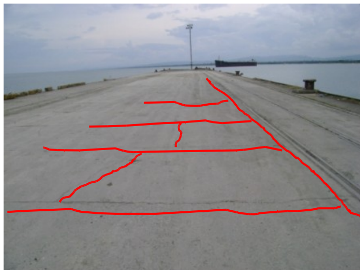
FIGURA 4.4 LOSA AGRIETADA DEL MUELLE 70
