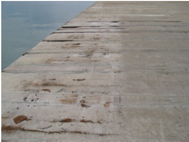
FIGURA 4.10 DESGASTE DE RAMPA RO/RO
