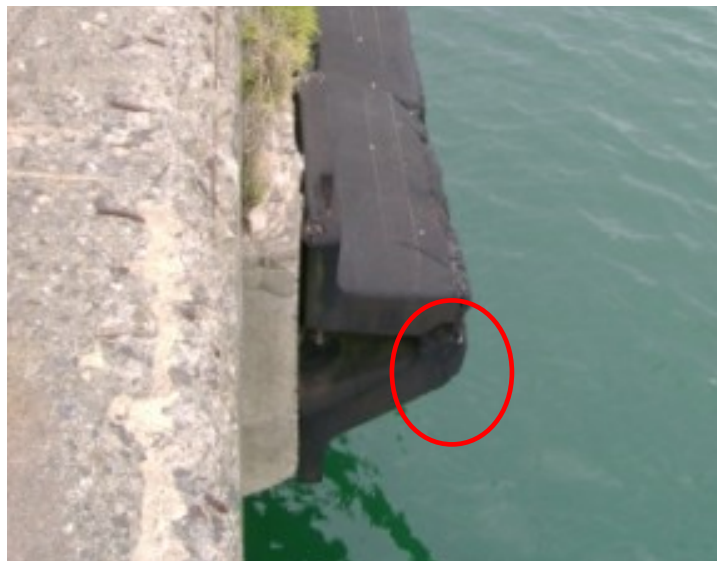
FIGURA 4.5 DEFENSA DAÑADA DEL MUELLE 70
