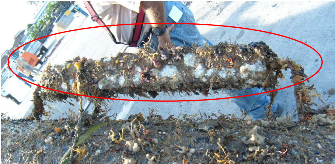
FIGURA 5.6 ÁNODO DE SACRIFICIO UTILIZADO EN MUELLE DE CRUCEROS
