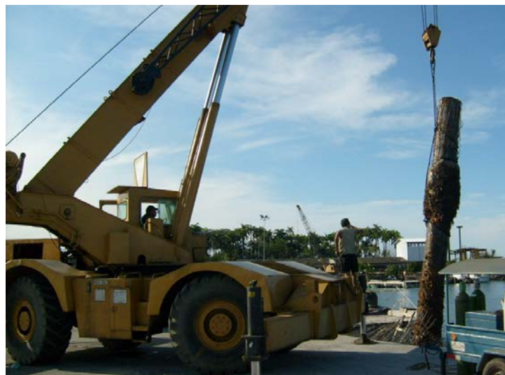
FIGURA 5.7 EXTRACCIÓN DE PILOTE DAÑADO
