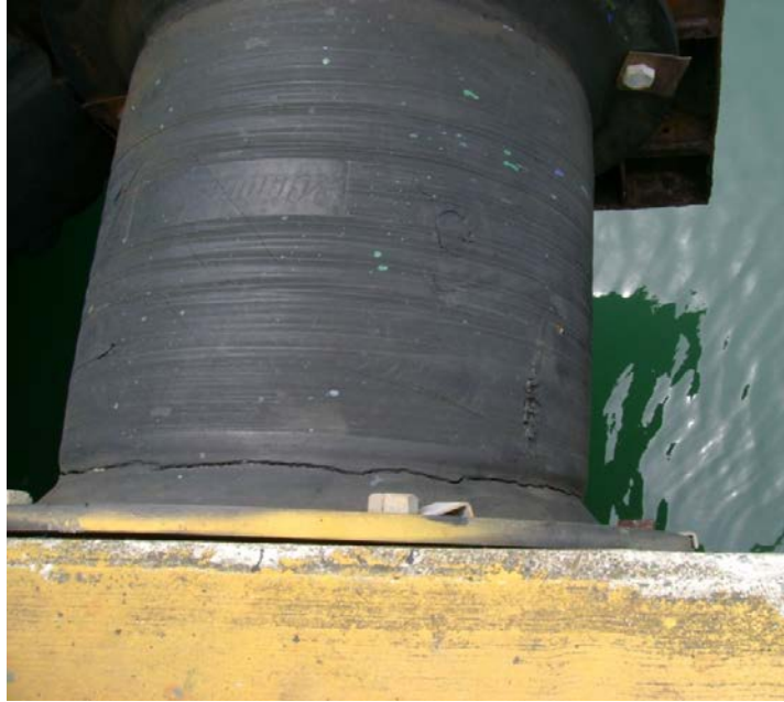
FIGURA 4.8 DEFENSA DAÑADA DEL MUELLE DE CRUCEROS
