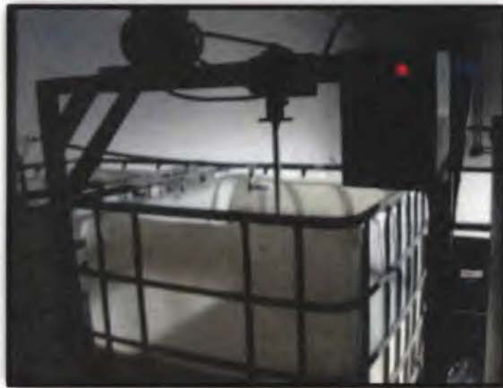
IMAGEN 4.5. ÁREA DE TANQUES
