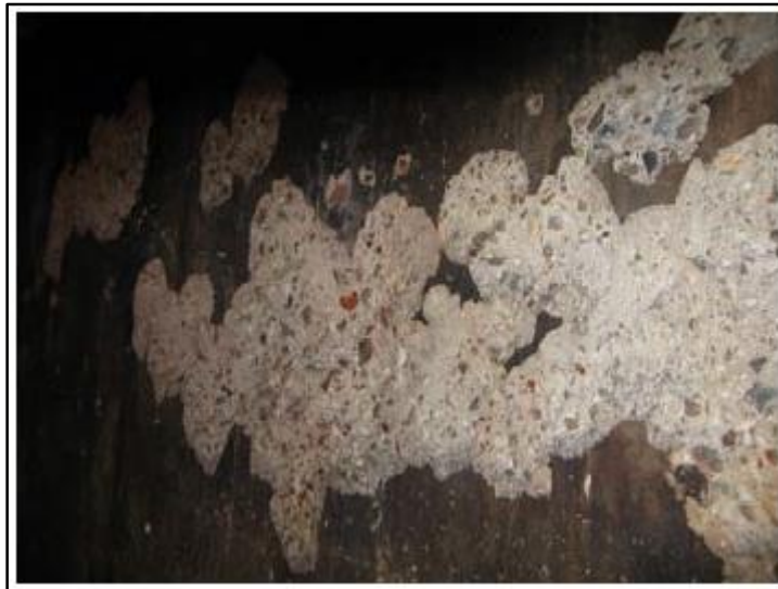
Imagen 5. Desprendimiento explosivo de las capas superficiales del concreto al exponerse a aumentos de temperatura.
