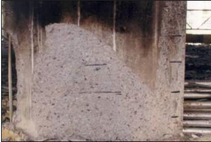
Imagen 6. Desprendimiento de esquinas.
