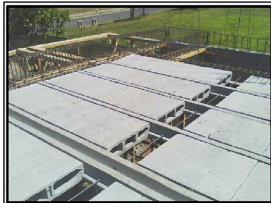
Imagen 19. Fotografía del montaje de un sistema de vigueta pretensado con bloques prefabricados.
