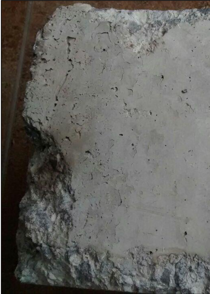
Imagen 56. Formación de astillas y grietas en losas sometidas a radiación durante 2 horas.
