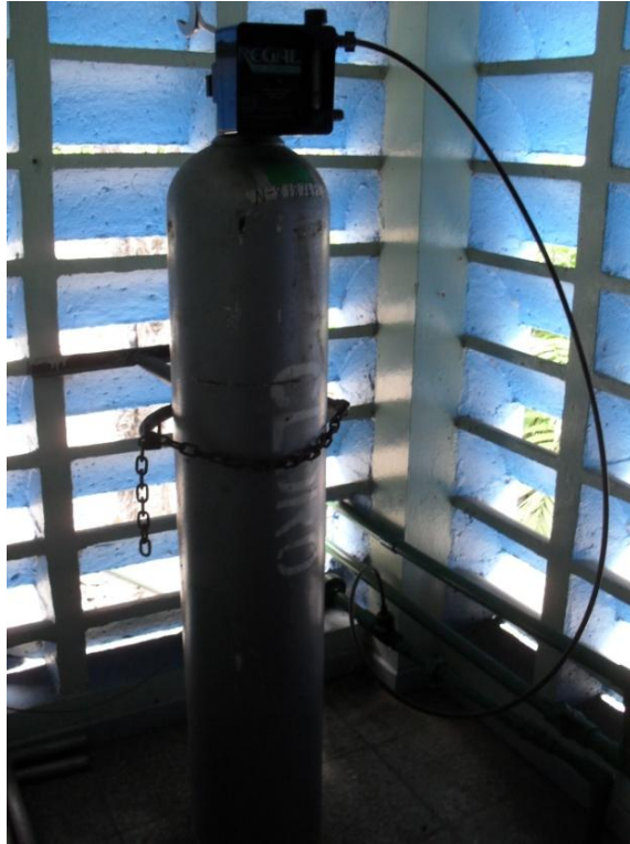
Figura 31: Sistema de cloración utilizado en la Planta de Alajuelita.
