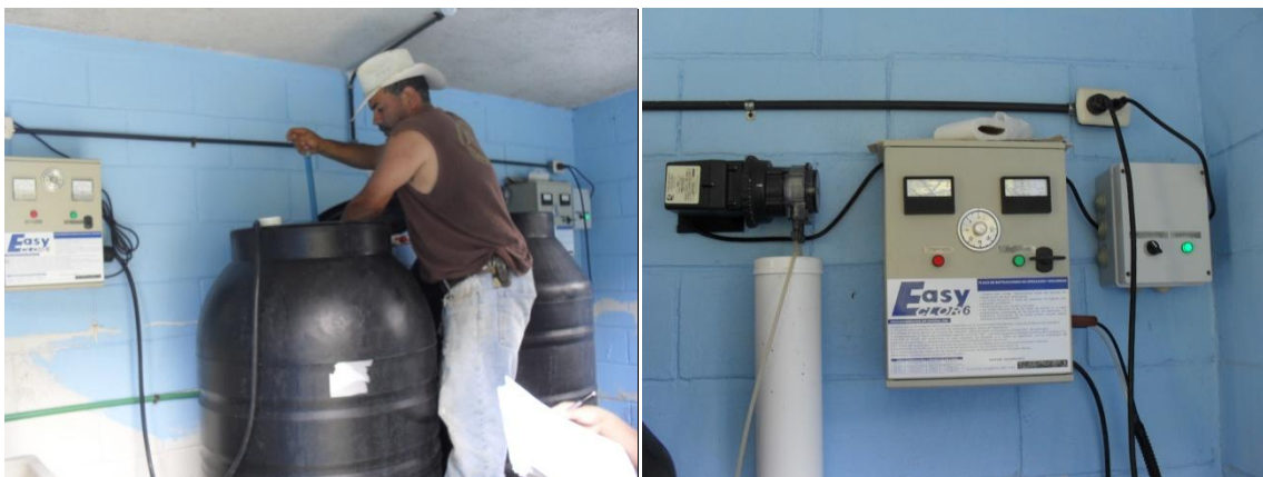
Figura 38: Planta de hipoclorito de sodio de Santa Cruz de Turrialba.
