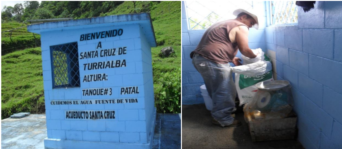
Figura 42: Caseta de cloración de Santa Cruz de Turrialba.
