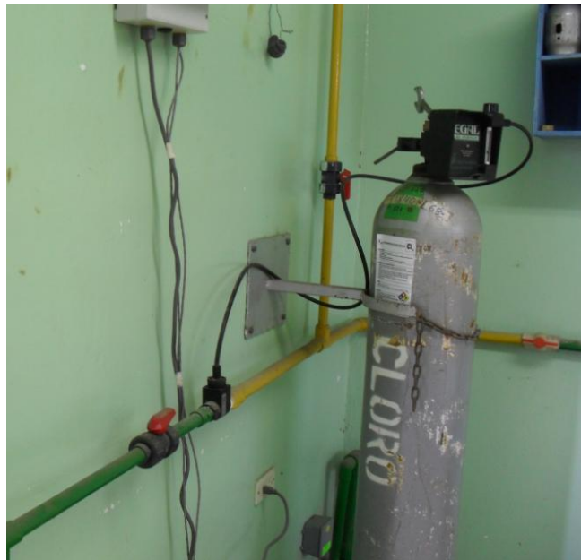
Figura 32: Sistema de cloración utilizado en la Planta de San Antonio de Escazú.
