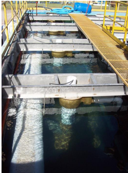
Figura 6: Sedimentador de una planta potabilizadora.
