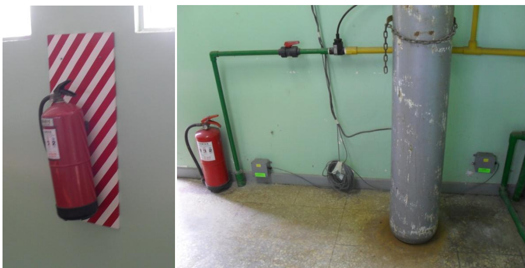
Figura 35: Presencia de extintores y respiradores en las plantas de cloro gas.
