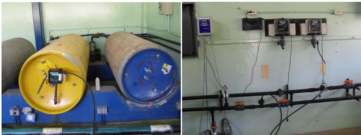
Figura 29: Sistema de post-cloración de la Planta de Guadalupe.
