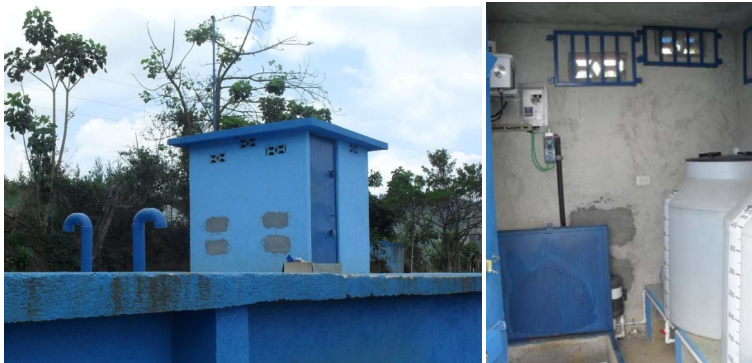
Figura 43: Caseta de cloración de la Parte Alta de Tobosi.
