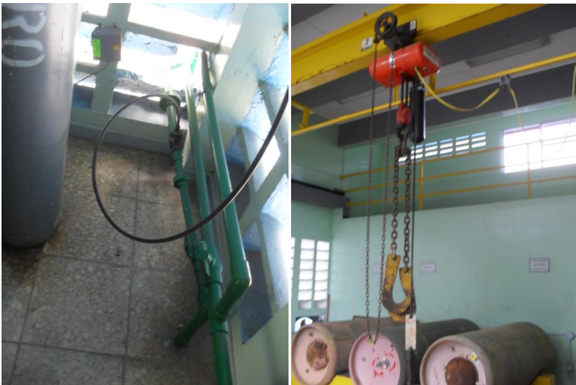
Figura 33: Entradas de aire, en las casetas de cloración, para una adecuada ventilación.
