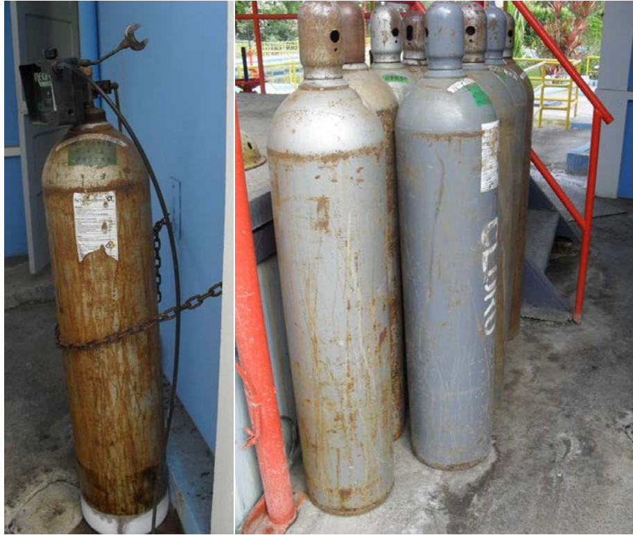
Figura 26: Sistema de pre-cloración y cilindros utilizados en la Planta Alta de Tres Ríos.
