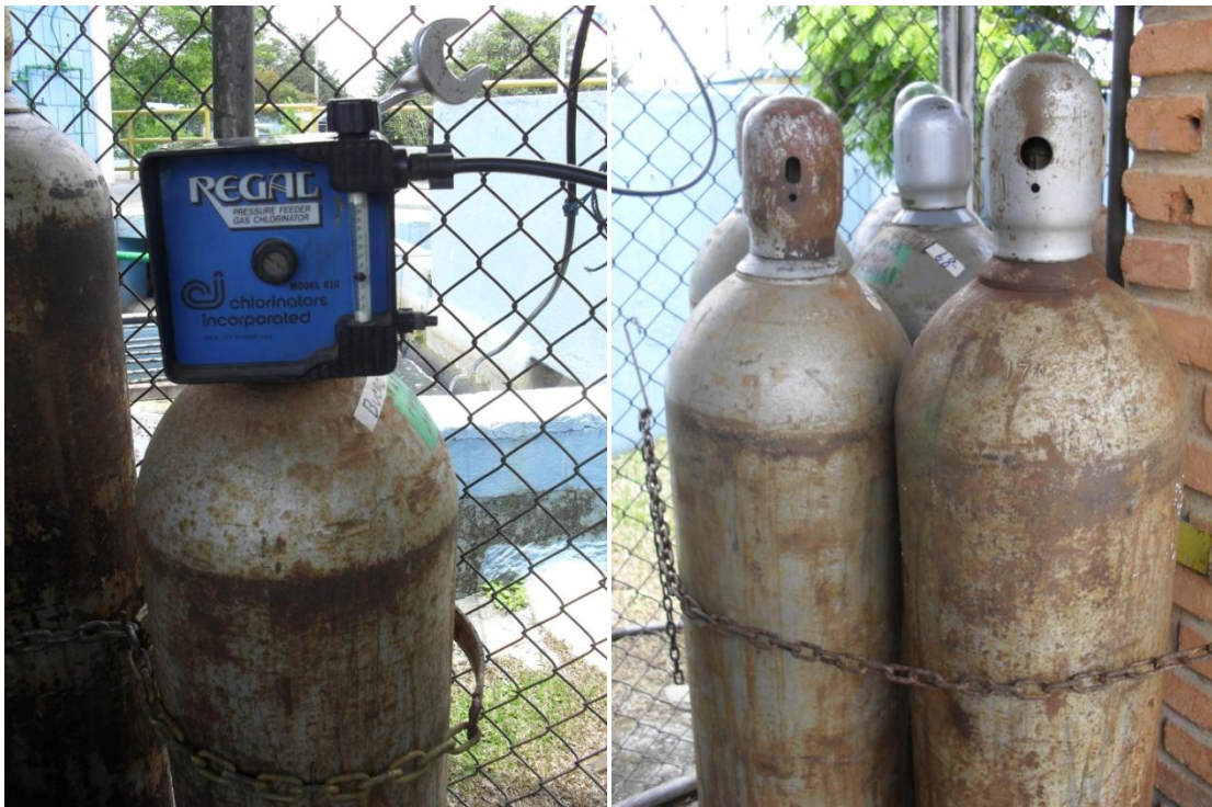
Figura 27: Sistema de pre-cloración y cilindros utilizados en la Planta de Guadalupe.
