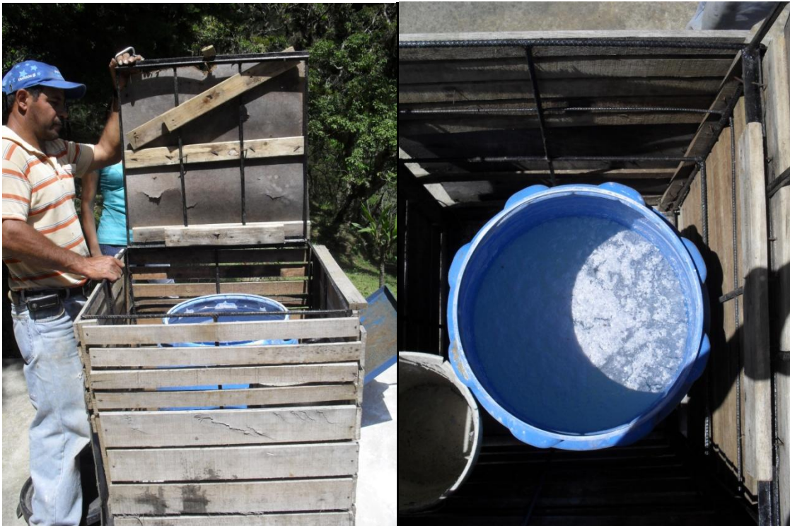
Figura 48: Equipo de hipoclorito de calcio granulado de Bermejo de Quebradilla.
