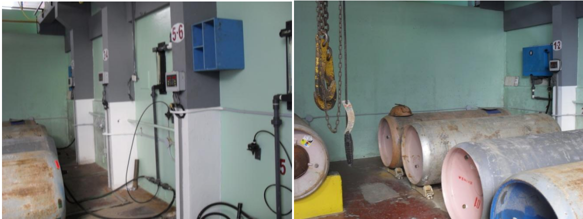
Figura 28: Sistema de post-cloración de Planta Alta de Tres Ríos.
