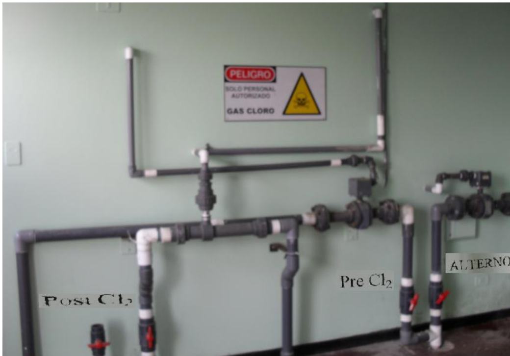
Figura 30: Tuberías para la dosificación del cloro.
