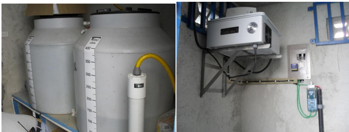
Figura 39: Equipo de hipoclorito de sodio utilizado en la Parte Alta de Tobosi.
