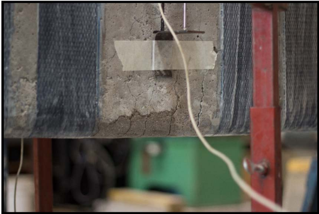
Figura F6. Grietas de flexión observadas en el espécimen VO-1 después del ensayo de falla.
