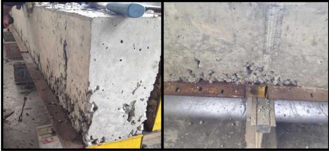
Figura 21. Defectos encontrados en los elementos colados el 26 de mayo.
