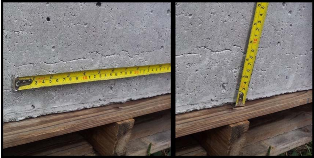
Figura 27. Grietas longitudinales a la altura del acero longitudinal de lecho superior.
