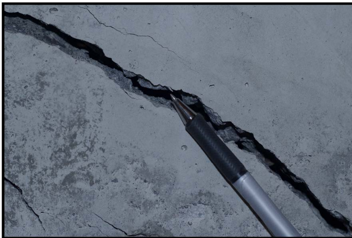
Figura F2. Grietas de cortante observadas en el elemento V-A después del ensayo de falla.
