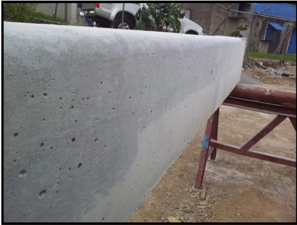
Figura 26. Imperfecciones en el concreto expuestas al remover la "lechada" superficial.
