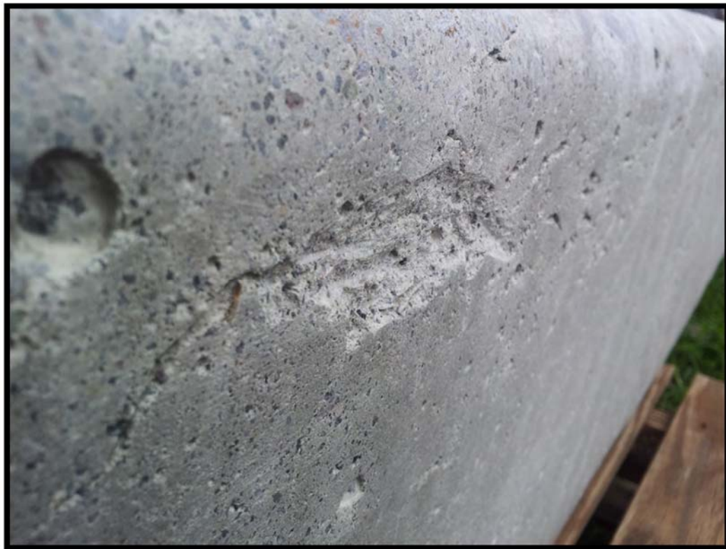
Figura 28. Exploración realizada a una de las grietas longitudinales encontradas.
