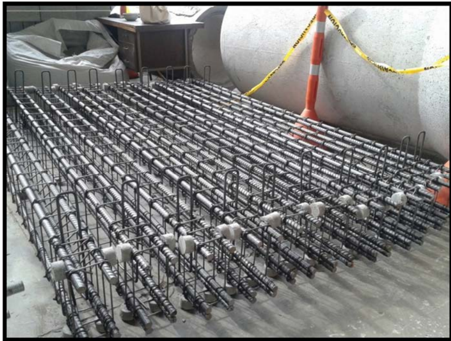
Figura 16. Estado final de armaduras de acero de refuerzo.
