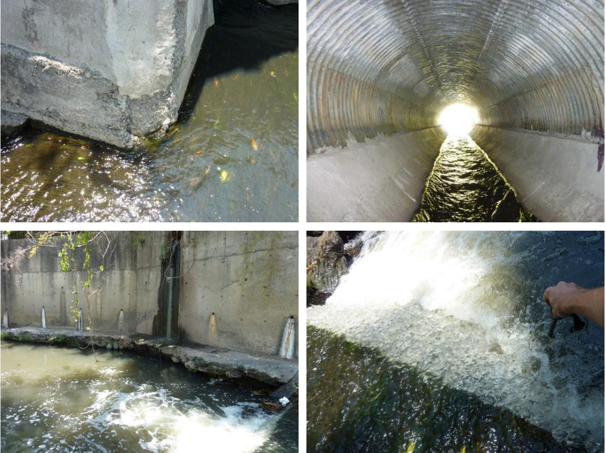
Figura 7-49. Problemas encontrados en Torres Este
