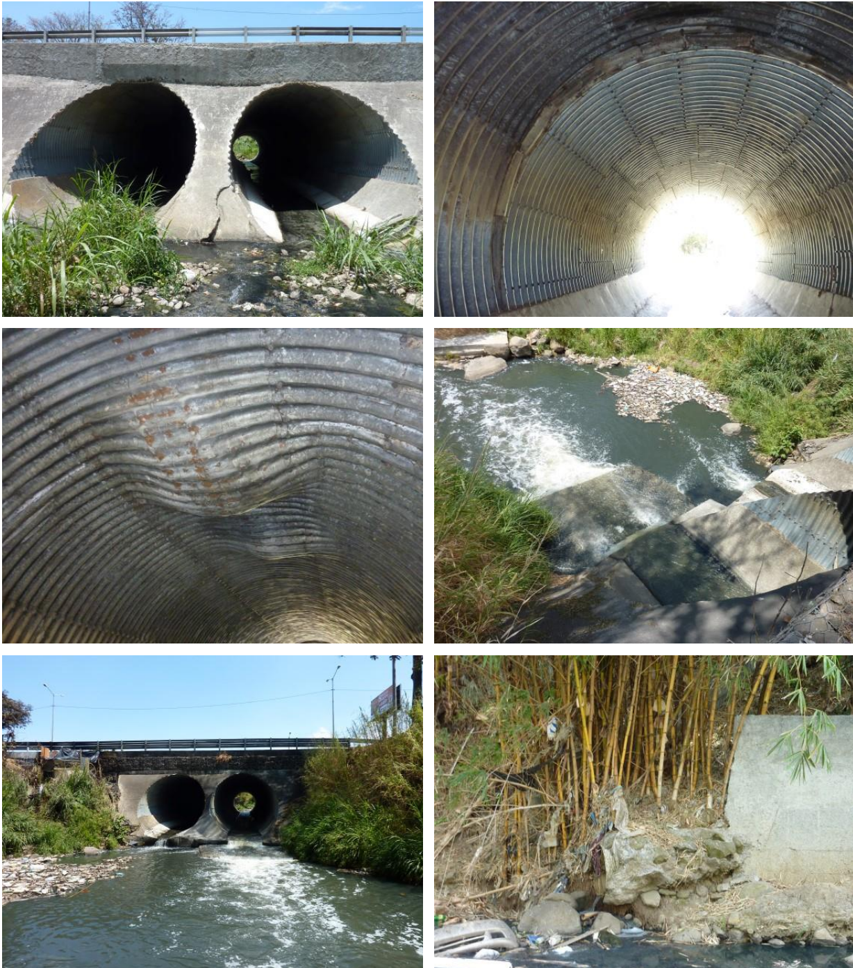
Figura 7-19. Problemas encontrados en María Aguilar Este.
