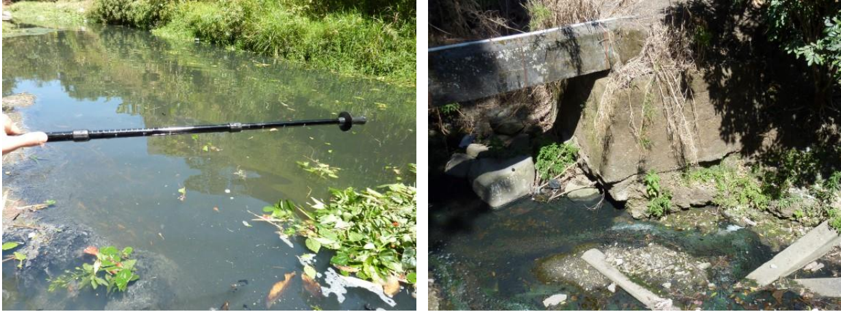
Figura 7-39. Problemas hidráulicos encontrados en Negritos.
