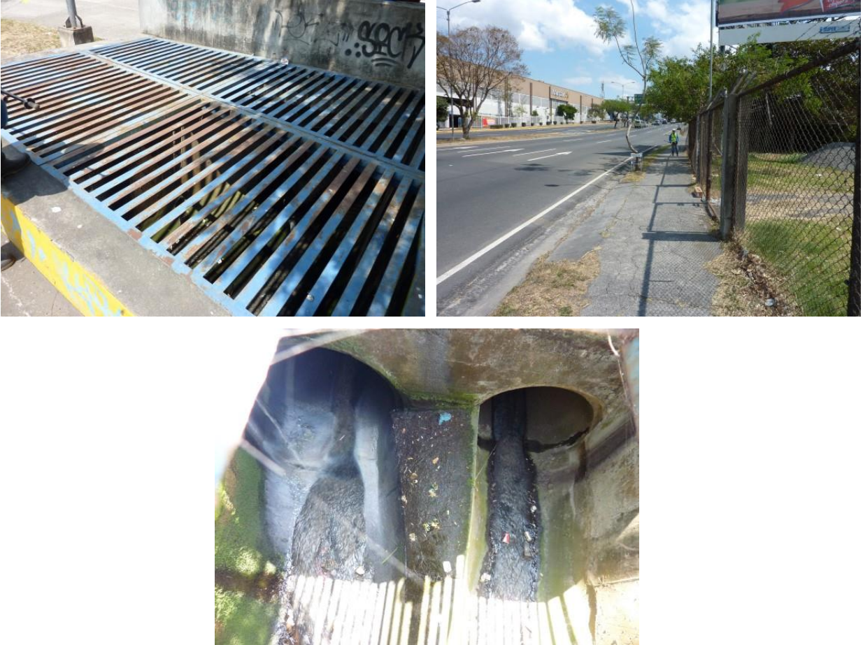
Figura 7-58. Falta de acceso a Cangrejos
