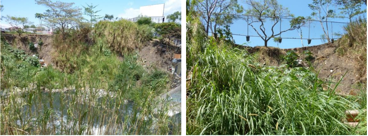
Figura 7-20. Problemas de daño a márgenes encontrados en María Aguilar Este.
