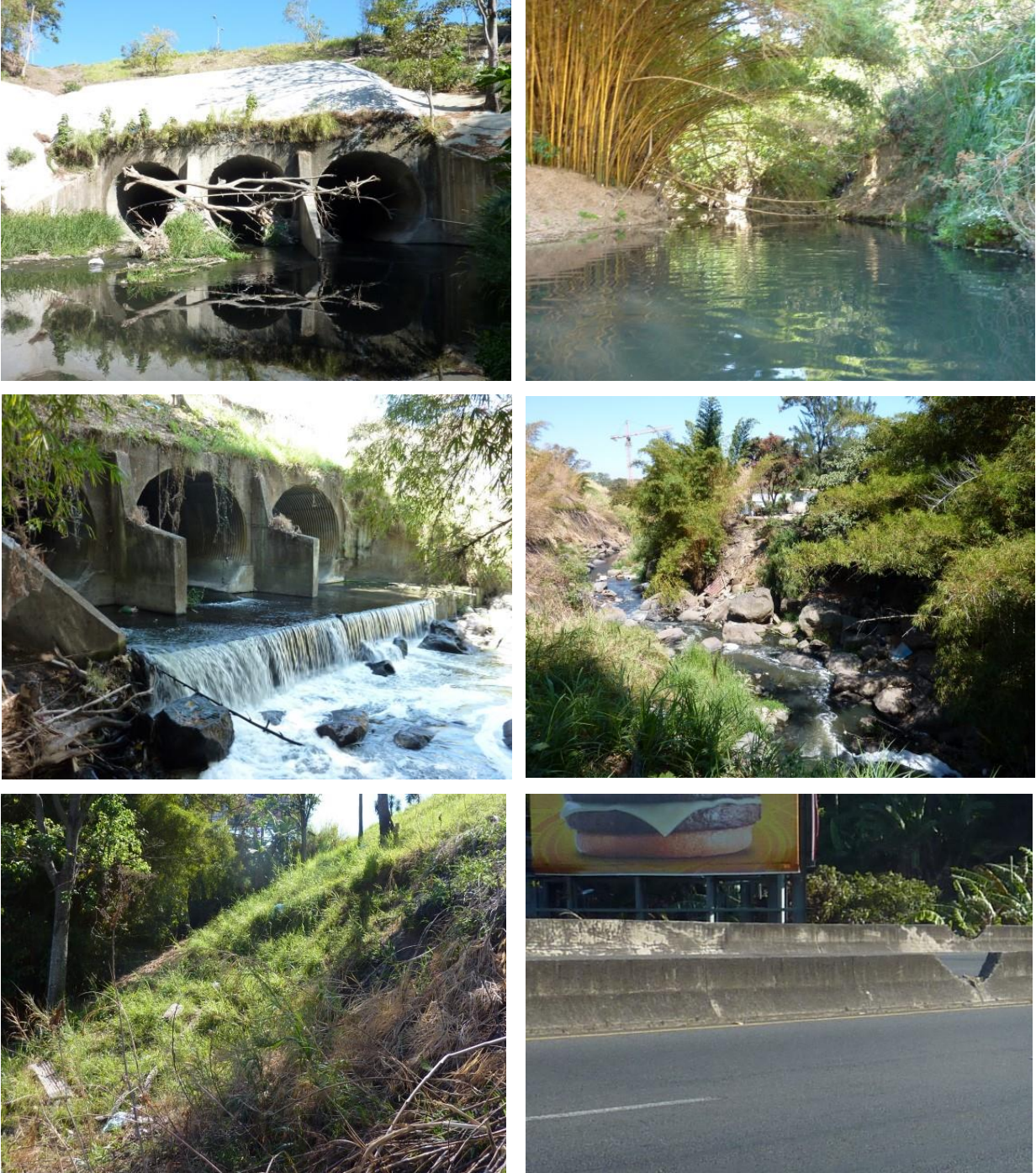
Figura 7-9. Problemas encontrados en Torres Oeste.
