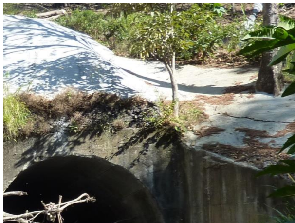
Figura 7-10 Problemas encontrados en Torres Oeste (cont.).
