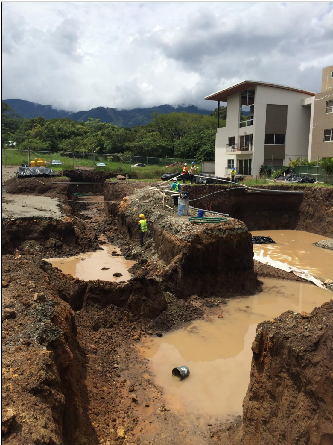
Figura 75. Fotografía que muestra los rellenos de fundación contaminados por el agua
