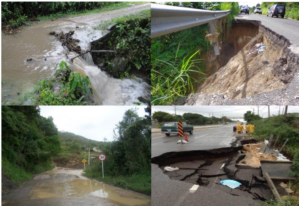
Figura 2.2. Daños producidos por deficiencias en los sistemas de drenaje.
