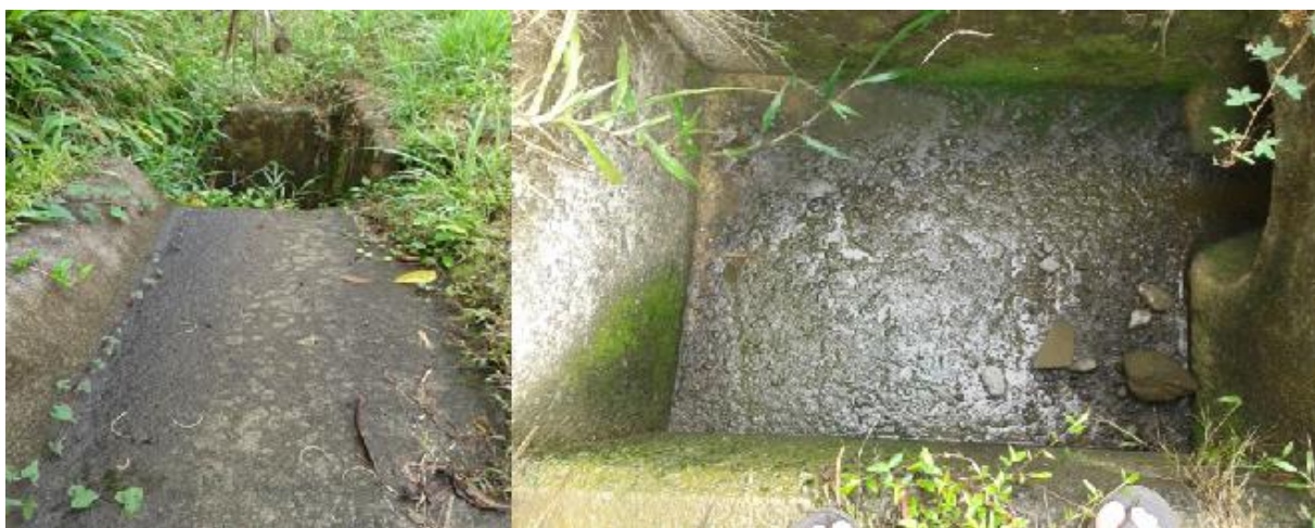
Figura 4.4. Cuneta típica en cabezales encontrados en Ruta 10, Siquirres-Turrialba.
