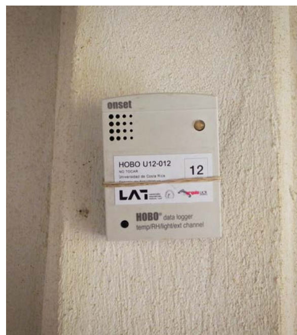
Imagen 5.68: Fotografía de la colocación de los dataloggers en la vivienda. Fuente: Autor
