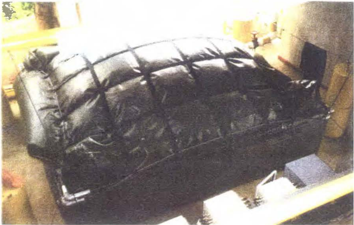
Figura 3.4.a Bolsa de almacenamiento del biogás producido por el reactor anaerobio del beneficio Coopelibertad R.L.
