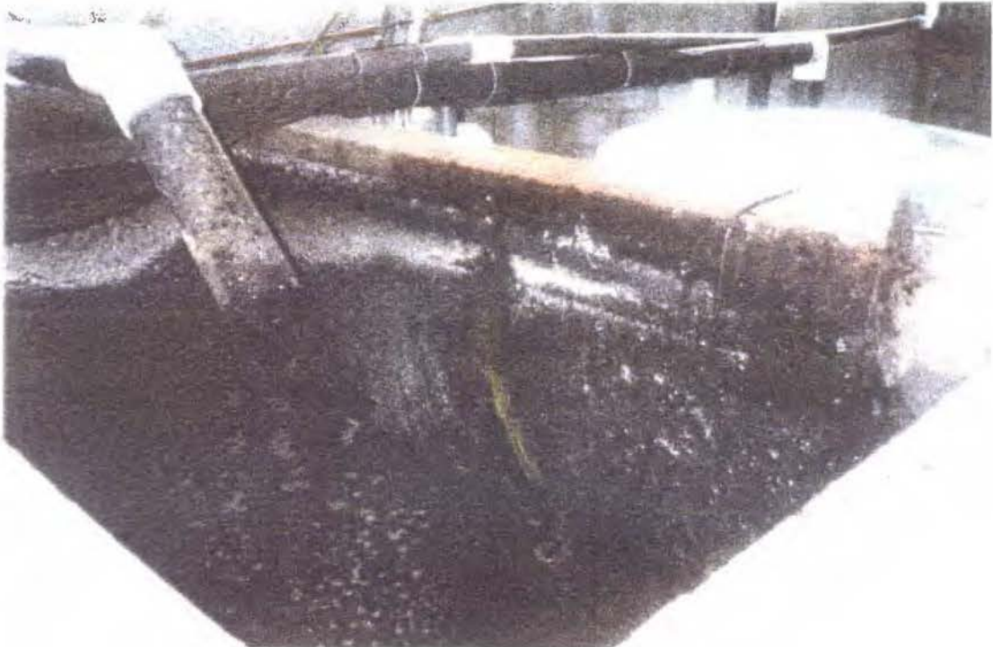
Figura 3.3.b Tanque de mezcla del reactor anaerobio en el Beneficio Coopelibertad R.L.
