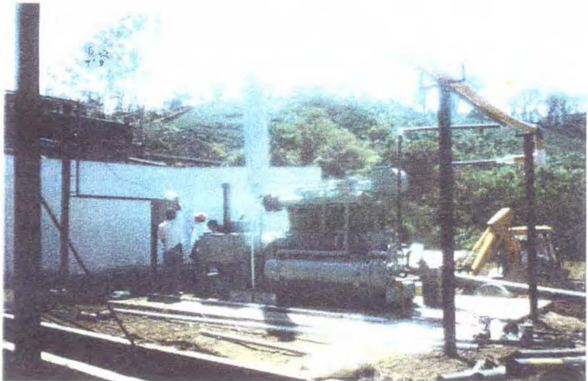
Figura 3.4.b Generador eléctrico que trabaja a partir del biogás producido por el reactor anaerobio del beneficio Coopelibertad R.L.
