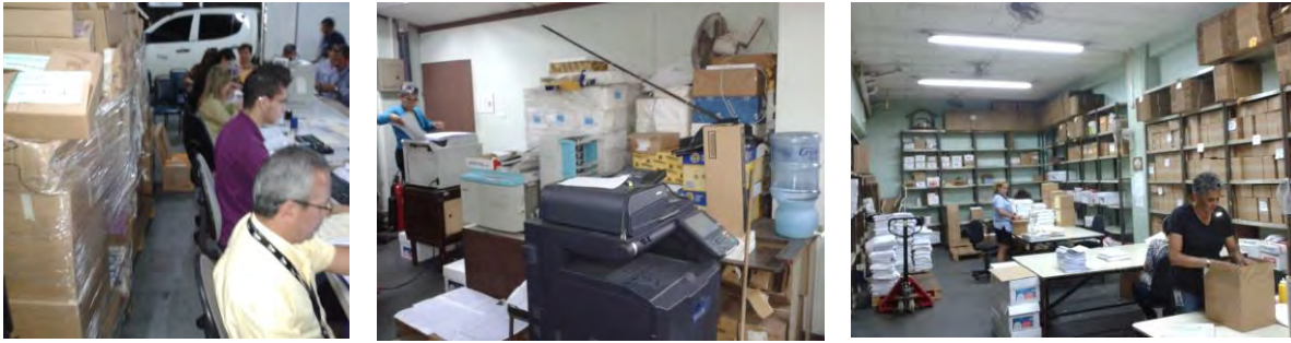
Figura 57. Estibas peligrosas de materiales cerca de personal o instalaciones eléctricas.
