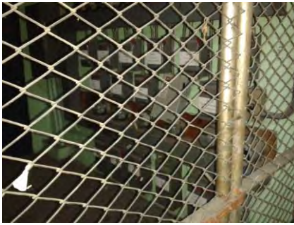
Figura 53. Instalaciones eléctricas de la DGEC.
