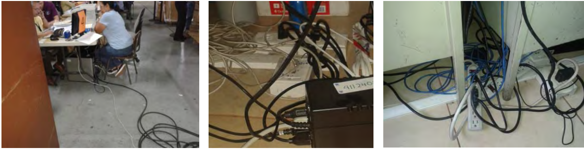
Figura 55. Conexiones improvisadas en las oficinas de la DGEC.
