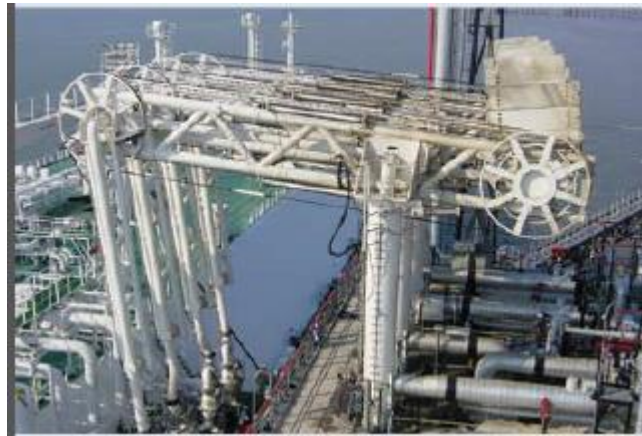
Figura 5.5. Brazo de descarga de GNL, modelo DCMA-S, marca FMC Technologies Fuente: FMC Technologies, 2014
