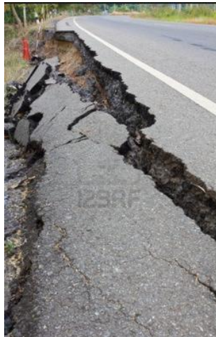
Figura 2.21. Erosión al costado de la calle.
