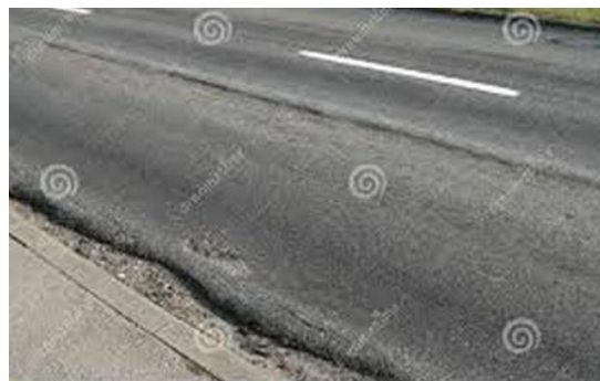
Figura 2.20. Ahuellamiento o roderas.
