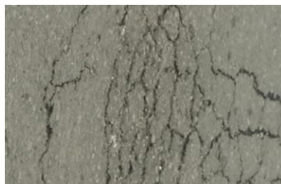
Figura 2.18. Grietas por contracción.
