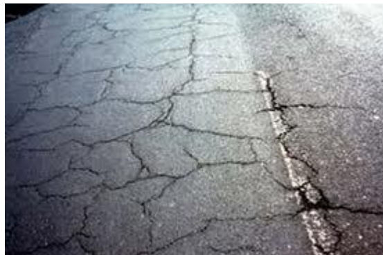
Figura 2.12. Pavimento asfáltico deteriorado, indicado para reciclado.
