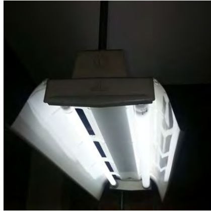
Figura 6.22 Luminaria encontrada en el edificio
