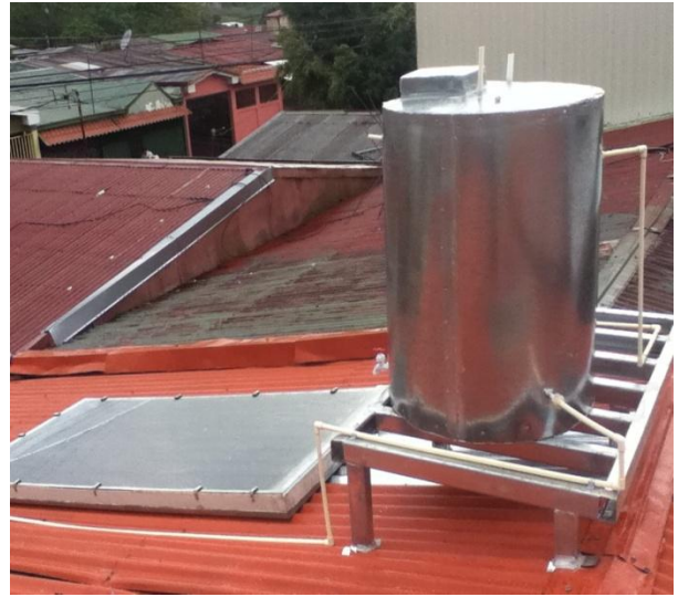
Ubicación final del colector y tanque de almacenamiento.
