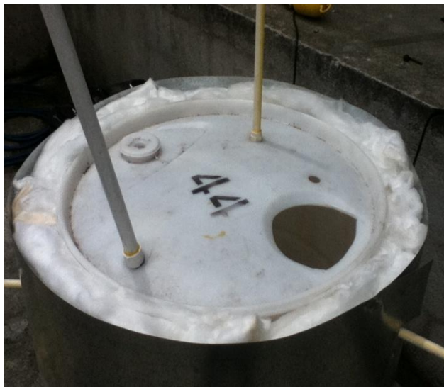
Aislamiento térmico del tanque de almacenamiento
