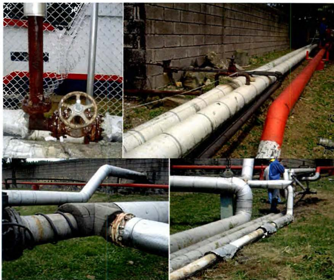
FIGURA 4.28 AISLAMIENTOS TÉRMICOS EN MAL ESTADO TUBERÍAS AFUERAS DEL DIQUE DEL TK 118
