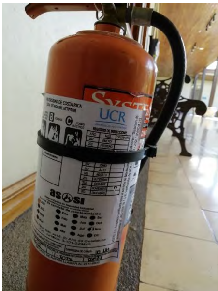
Fotografía 16 Extintor ABC a la par del baño de mujeres
