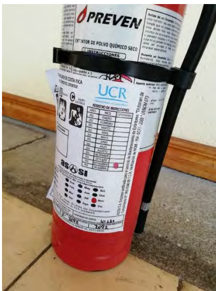
Fotografía 17 Extintor ABC a la par del comedor
