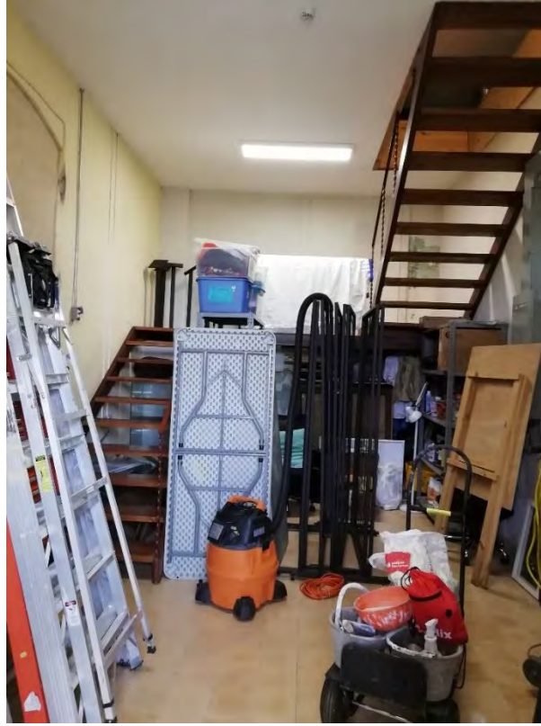
Fotografía 28 Cuarto eléctrico usado como bodega
