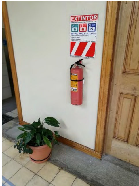
Fotografía 11 Extintor al lado del comedor
