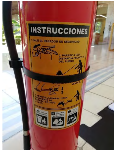
Fotografía 15 Extintor ABC a la par del panel de control principal
