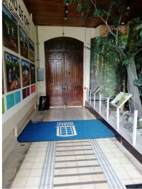
Fotografía 22 Segundo medio de egreso permanece cerrado
