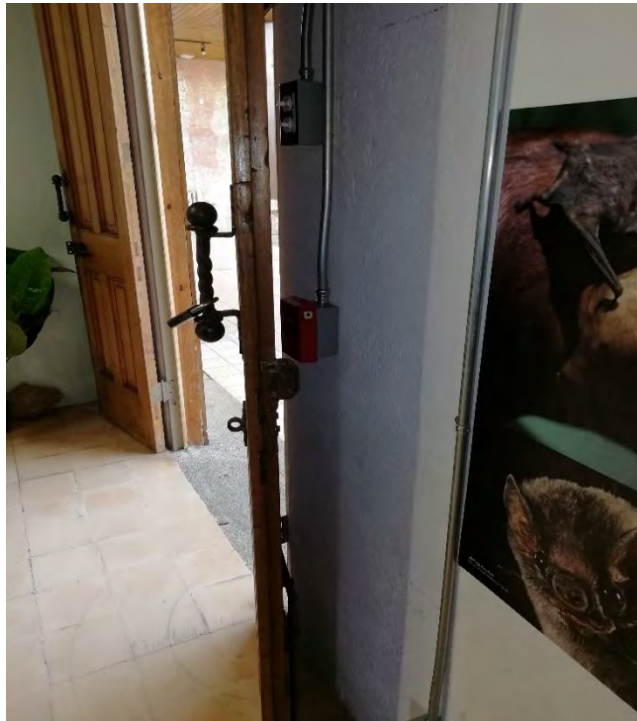
Fotografía 1 Estación manual obstruida por la puerta
