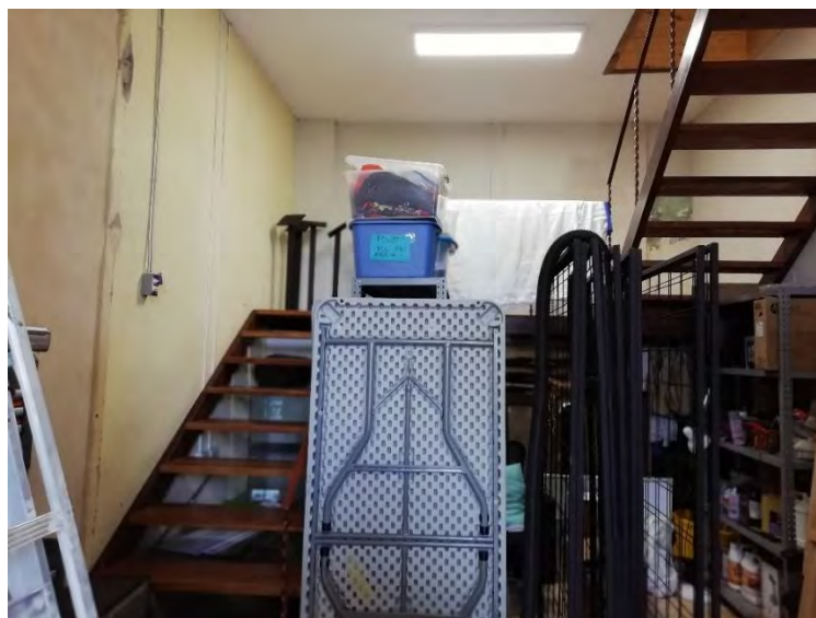
Fotografía 27 Cuarto eléctrico usado como bodega
