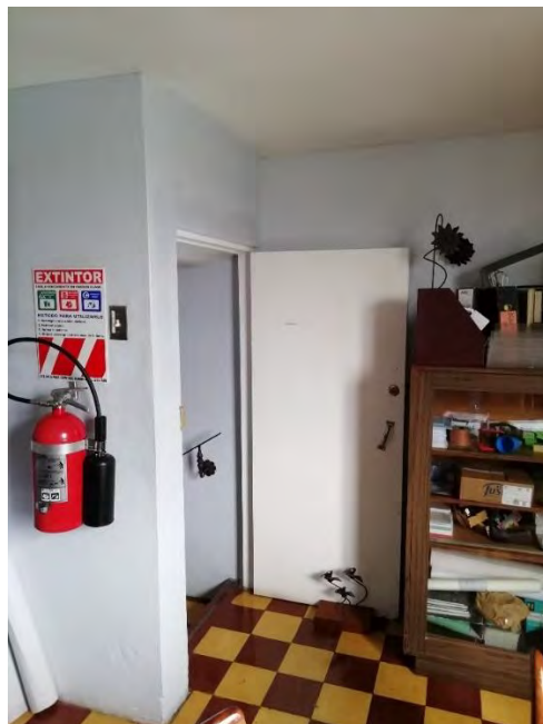
Fotografía 12 Extintor en sala de profesores
