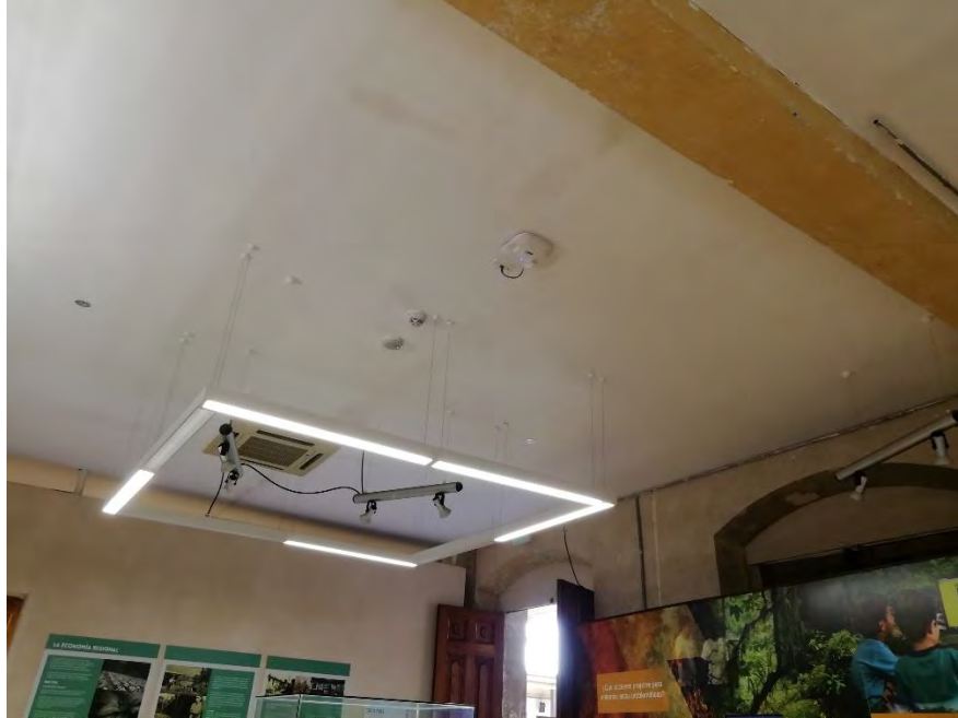
Fotografía 20 Detector de humo en sala de exhibición
