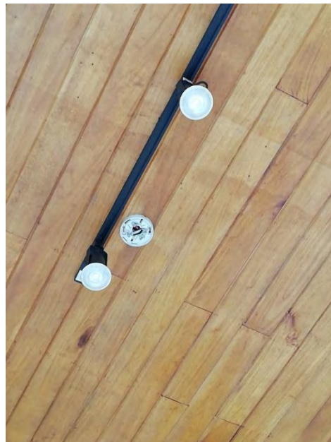
Fotografía 7 Detector de humo dañado en pasillo
