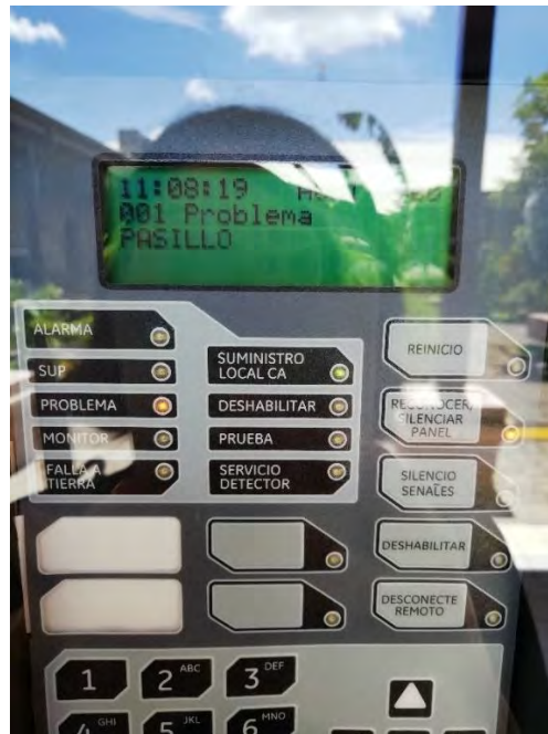
Fotografía 6 Panel de control con problema y silenciado
