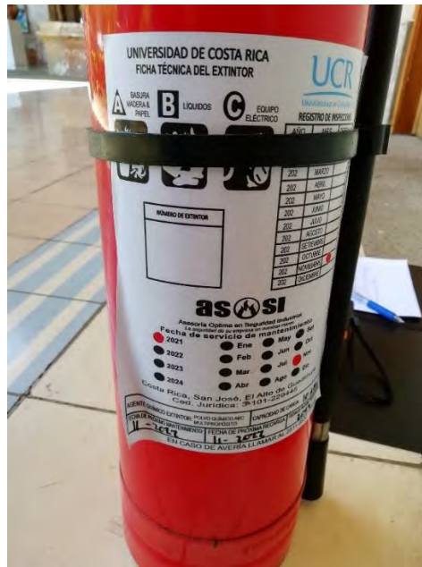
Fotografía 14 Extintor ABC a la par del panel de control principal
