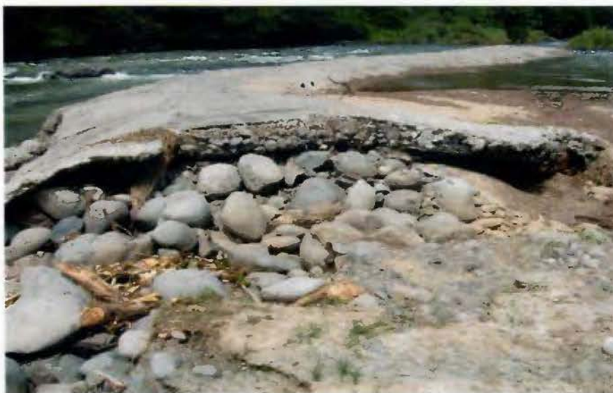
Figura #24: Efecto de las crecidas del río Barranca sobre el dique de la toma que esta ubicado en el puente sobre la carretera interamericana.
