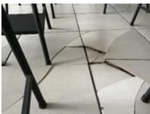
Figura 2. Levantamiento de acabados de piso debido a deflexión de losas, alto impacto
