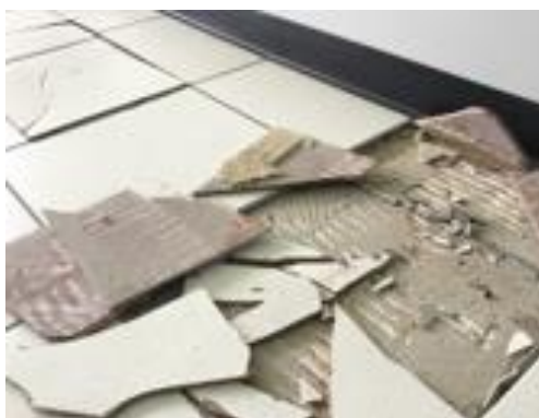
Figura 3. Levantamiento de acabados de piso debido a deflexión de losas, alto impacto
