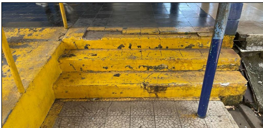
Figura 44. Escaleras sin pasamanos en ambos lados, con bordes fracturados, sin uniformidad dimensional y sin antideslizante
