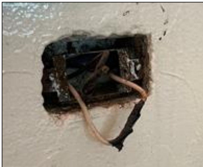
Figura 36. Salida de cableado sin protección y conexión de conductores por medio de tape negro
