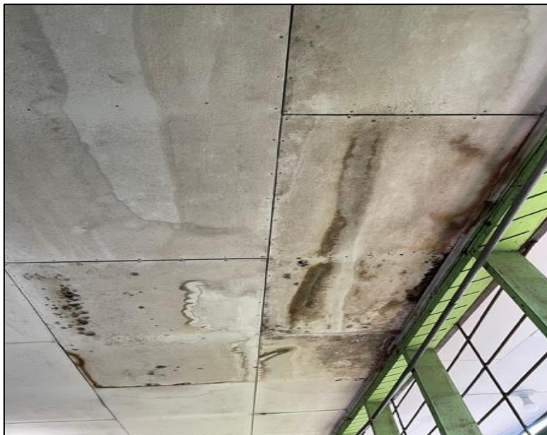
Figura 25. Deterioro por humedad de cielos de Fibrolit
