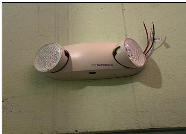
Figura 45. Lámpara de emergencia sin conexión
