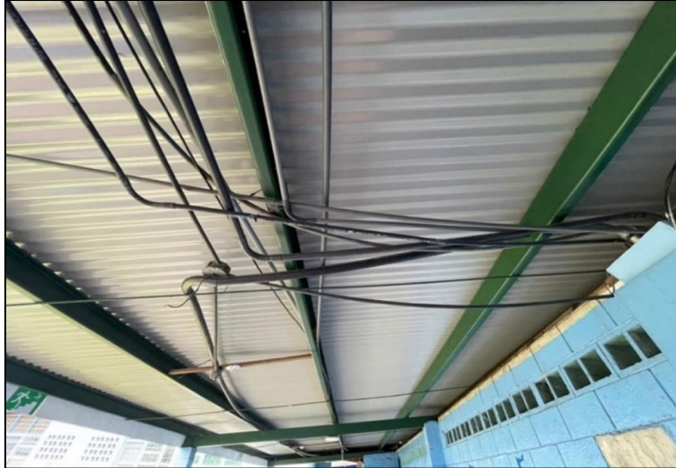
Figura 32. Canalización de conductores eléctricos en el sector intervenido en el 2020
