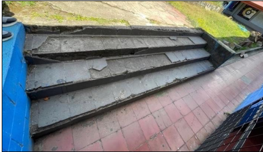
Figura 15. Deterioro recurrente en escaleras
