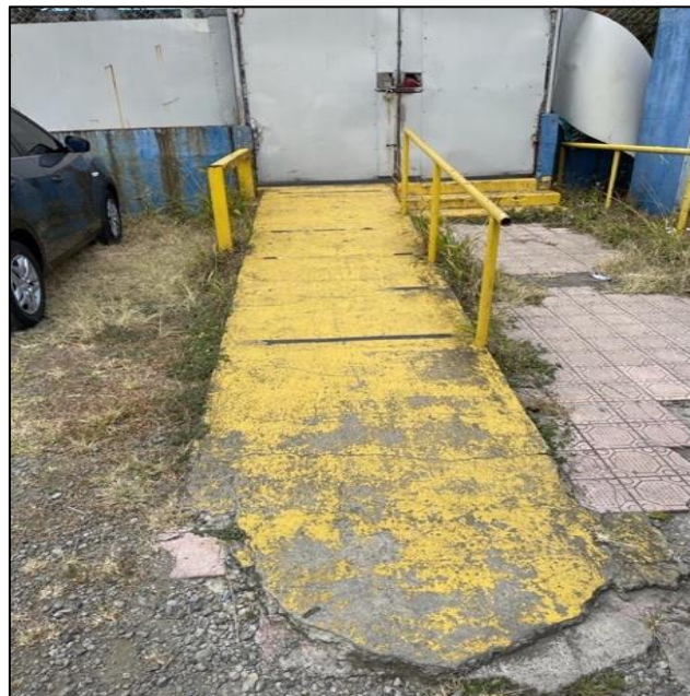
Figura 56. Rampa con desgaste de la superficie y sin antideslizante
