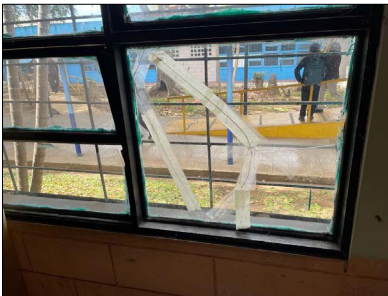
Figura 23. Deterioro de ventanas por quebraduras
