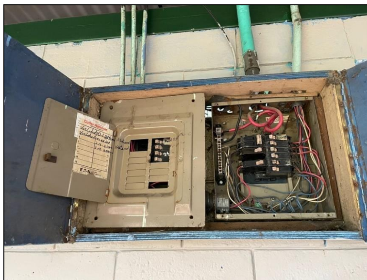
Figura 30. Tableros de distribución eléctrica, expuestos, en gabinete de madera en deteriorado, sin aterrizaje, sin identificación de circuitos ni cumplimiento de código de colores de los cables conductores
