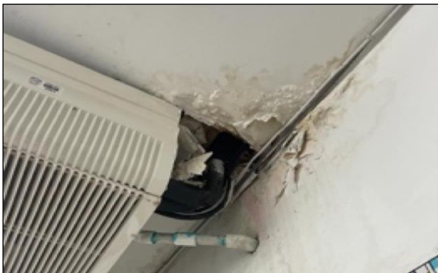
Figura 27. Deterioro de cielo de Gypsum en el laboratorio de cómputo N.2
