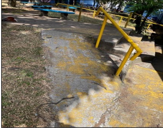
Figura 55. Rampa con 13% de pendiente con incumplimiento
