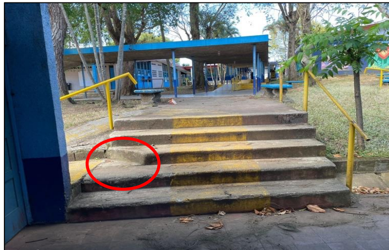
Figura 53. Escaleras con reducción abrupta de su ancho
