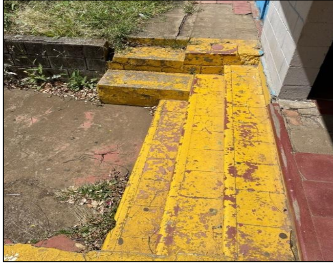
Figura 54. Escaleras sin uniformidad
