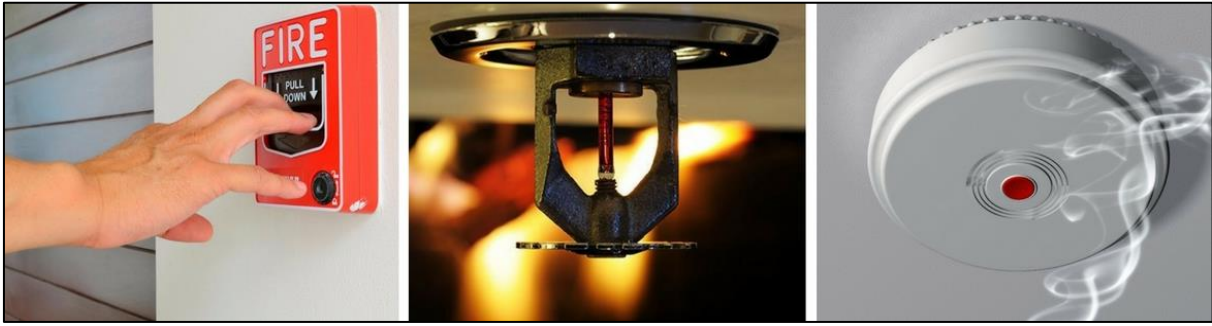
Figura 7. Palanca de aviso de incendio, rociador automático y detector de humo, respectivamente
