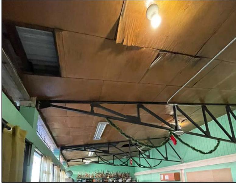
Figura 24. Deterioro de cielos de Plywood
