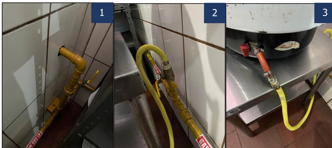
Figura 40. Instalación interna de gas LP en la cocina del comedor estudiantil del Liceo del Sur
