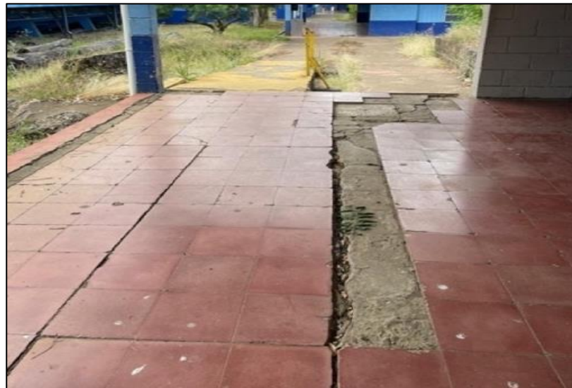
Figura 16. Deterioro recurrente en pasillos
