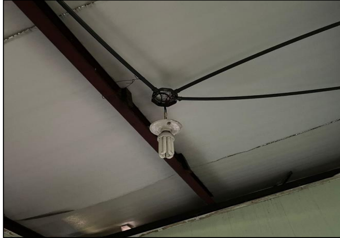
Figura 37. Plafón colgando de cables conductores eléctricos y sin soporte
