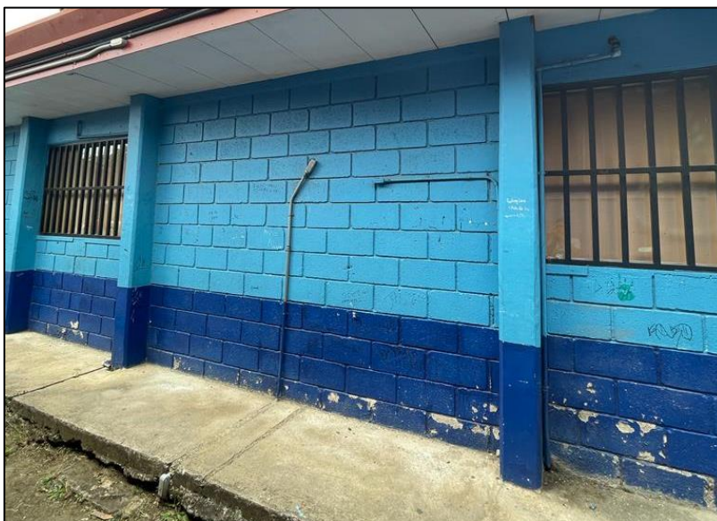
Figura 17. Estado de las paredes de mampostería
