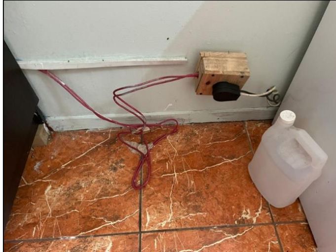
Figura 33. Tomacorriente sin canalización de cables conductores, sin aterrizaje y en una caja de madera
