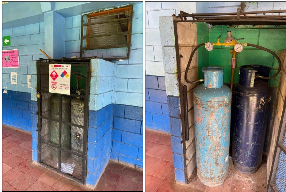
Figura 39. Instalación externa de gas LP de la cocina del comedor estudiantil del Liceo del Sur
