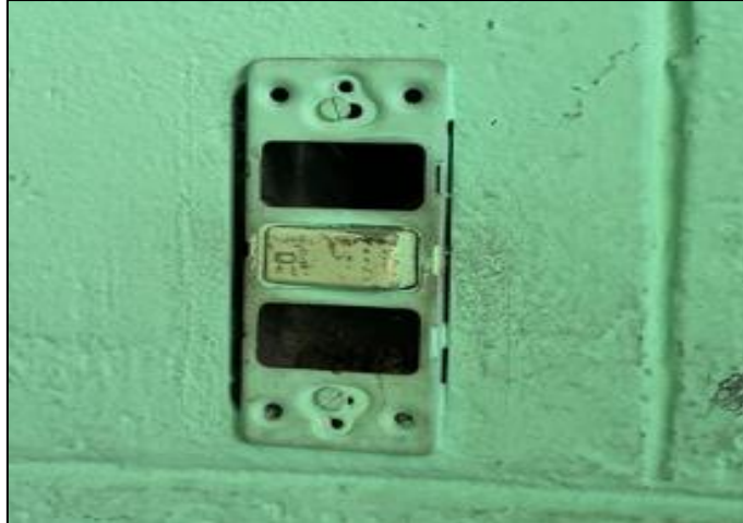
Figura 35. Interruptor sin cobertor
