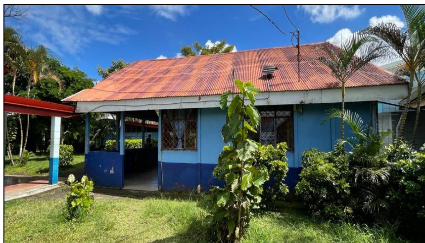
Figura 28. Deterioro de láminas de hierro galvanizado en la estructura de techos de la soda
