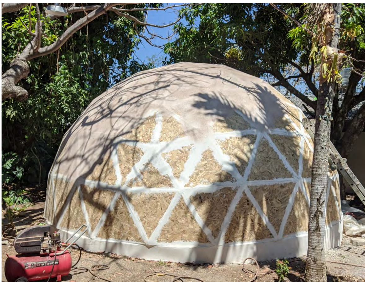
Figura 24. Colocación de primera capa de corcho proyectado en domo geodésico ubicado en Santa Ana, Costa Rica
