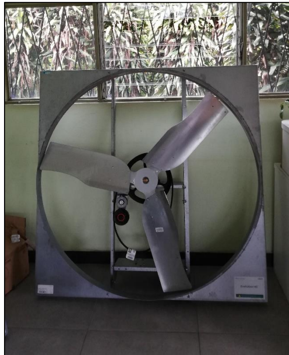
Figura 14. Ventilador instalado en la sala de espera de la EEAVM
