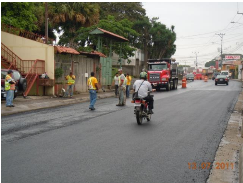
Ilustración 10. Fotografía durante la ampliación de la Calle Real. Recuperada de: por LanammeUCR (2011).
