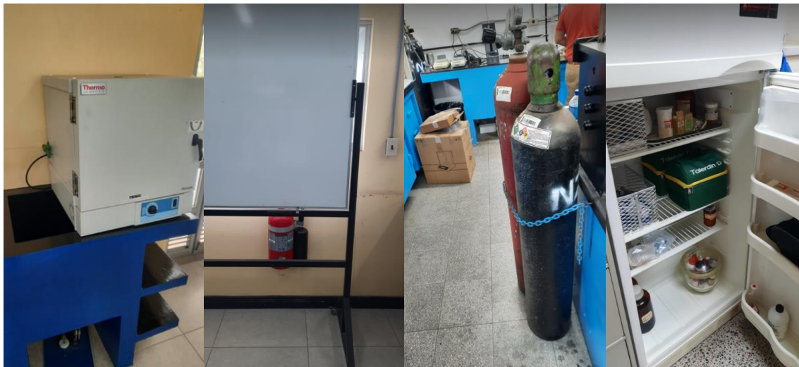
Figura E.22 Fotografías de las instalaciones del laboratorio, un extintor mal colocado y cilindros de hidrógeno y nitrógeno de la Escuela de Química.
