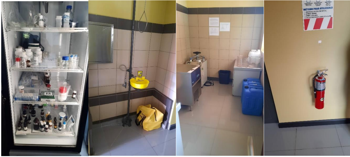
Figura E.28 Fotografías de la ducha de emergencia, lavajos, refrigeradores, instalaciones y cilindro extintor del Jardín Botánico Lankester.
