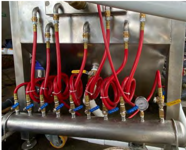
Figura 27. Válvulas de bola y manómetro del tanque de presurización entrando al DAF.
