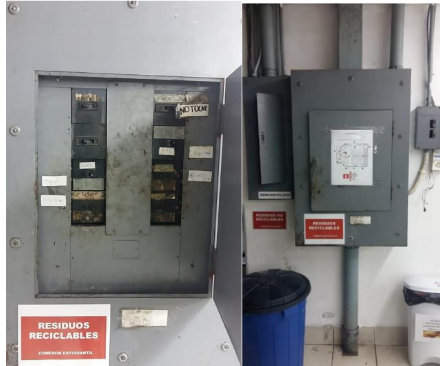
Figura 4.3.1. Breaker de equipos principales de la cocina (Elaboración propia)
