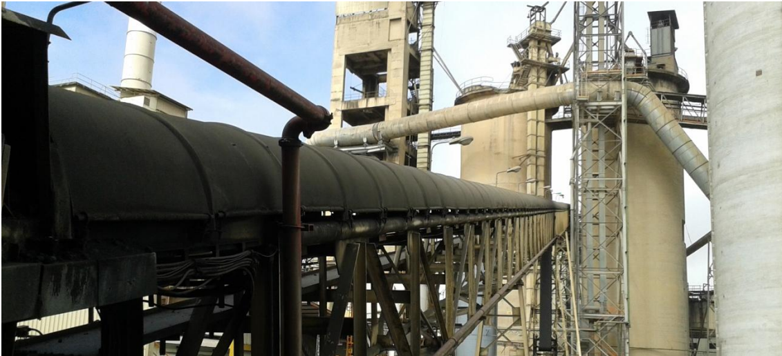
Figura 4. 2 Banda transportadora para el traslado del coque de petróleo
