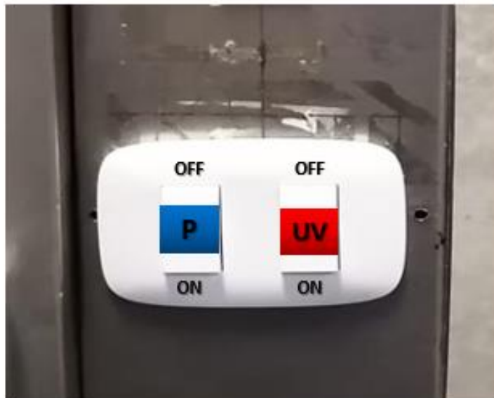
Figura E.2. Botones de activación para los sistemas de aspersión y radiación en posición de apagado.
