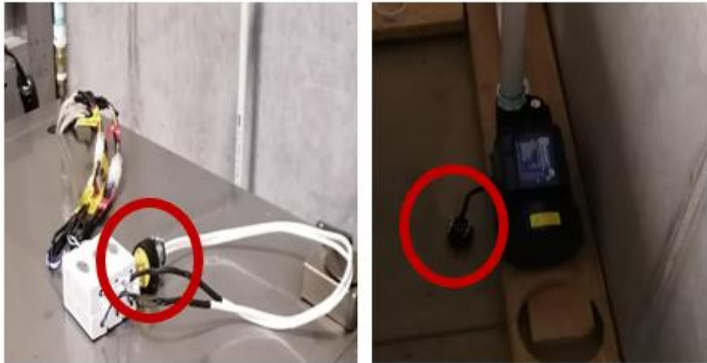
Figura E.1. Alimentación a los sistemas de radiación y aspersión desconectadas.
