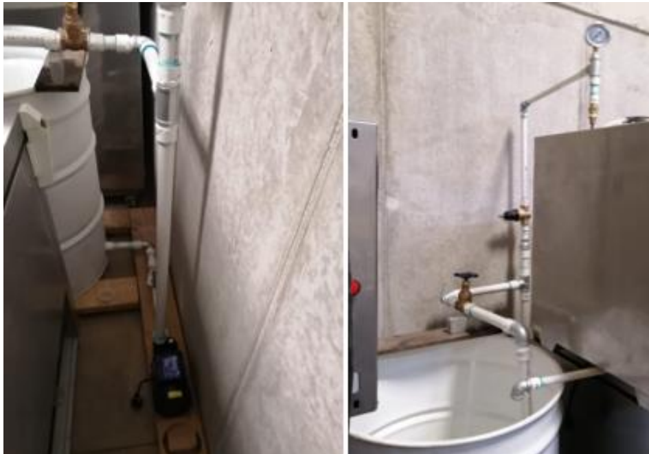
Figura 2.14. Detalle de la sección del sistema de aspersión en PVC y hierro galvanizado.
