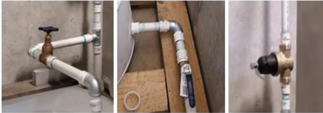
Figura E.3. De izquierda a derecha: válvulas del Bypass de presión, de la entrada de la bomba y reguladora de presión.
