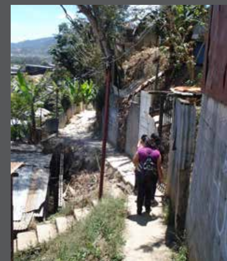
IM.97. Esta vía peatonal en Miravalles 2 es ejemplo de las zonas de riesgos donde se ve imposibilitada la intervención.
