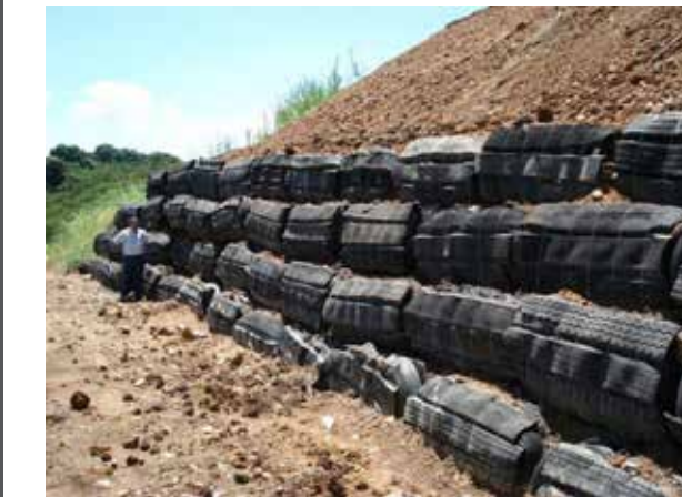
IM.110. Ejemplos de retención de terreno con llantas propuestas para el Sector.
