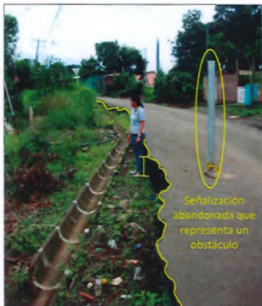
Figura 11. Vías afectadas producto del sismo de Sámara del 5 de setiembre
