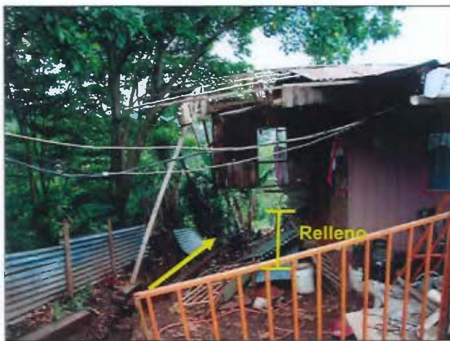
Figura 10. Vivienda afectada por asentamientos en relleno
