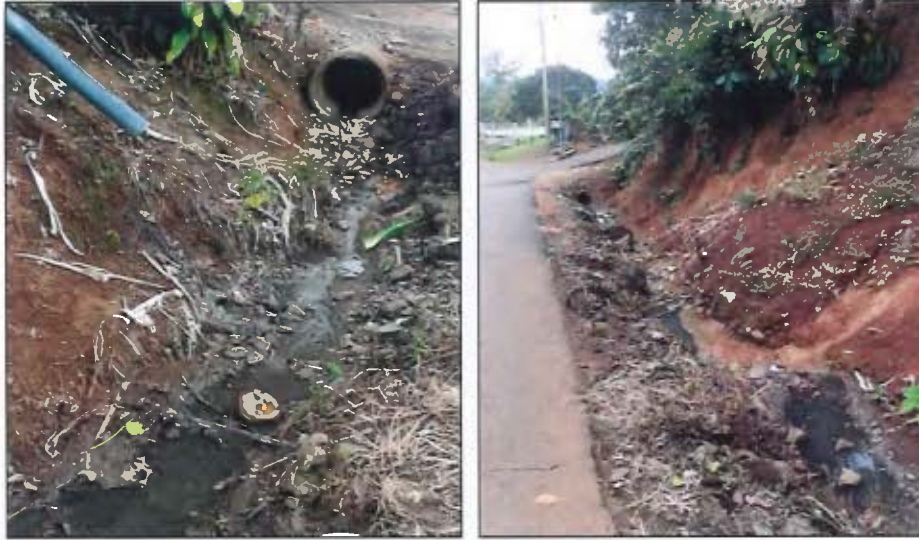
Figura 15. Desecho inadecuado de aguas residuales
