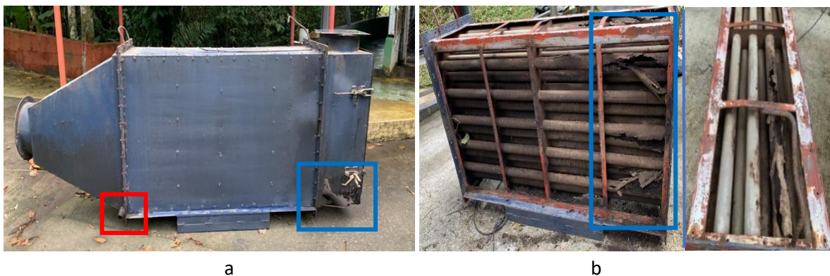
Figura 4.5. a) Intercambiador de calor desinstalado con detalle de fallo en espejo trasero y b) cuerpo de banco de tubos del intercambiador de calor sin la coraza con detalle de fallo de tubos.
