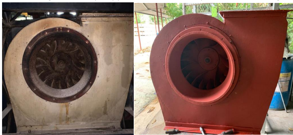
Figura 3.7. Fotografía del antes y después de realizar mantenimiento del equipo de ventilación.
