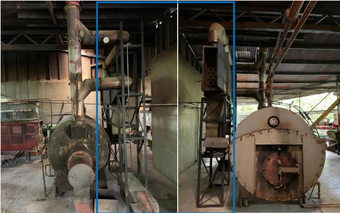
Figura 4.1. Fotografías de la caldera pirotubular y el sistema recuperador acoplado.
