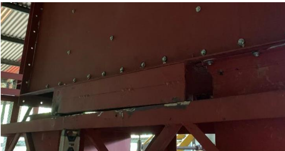
Figura 4.11. Detalle de desnivel en la base del intercambiador para promover el drenado de condensados a nivel interno.
