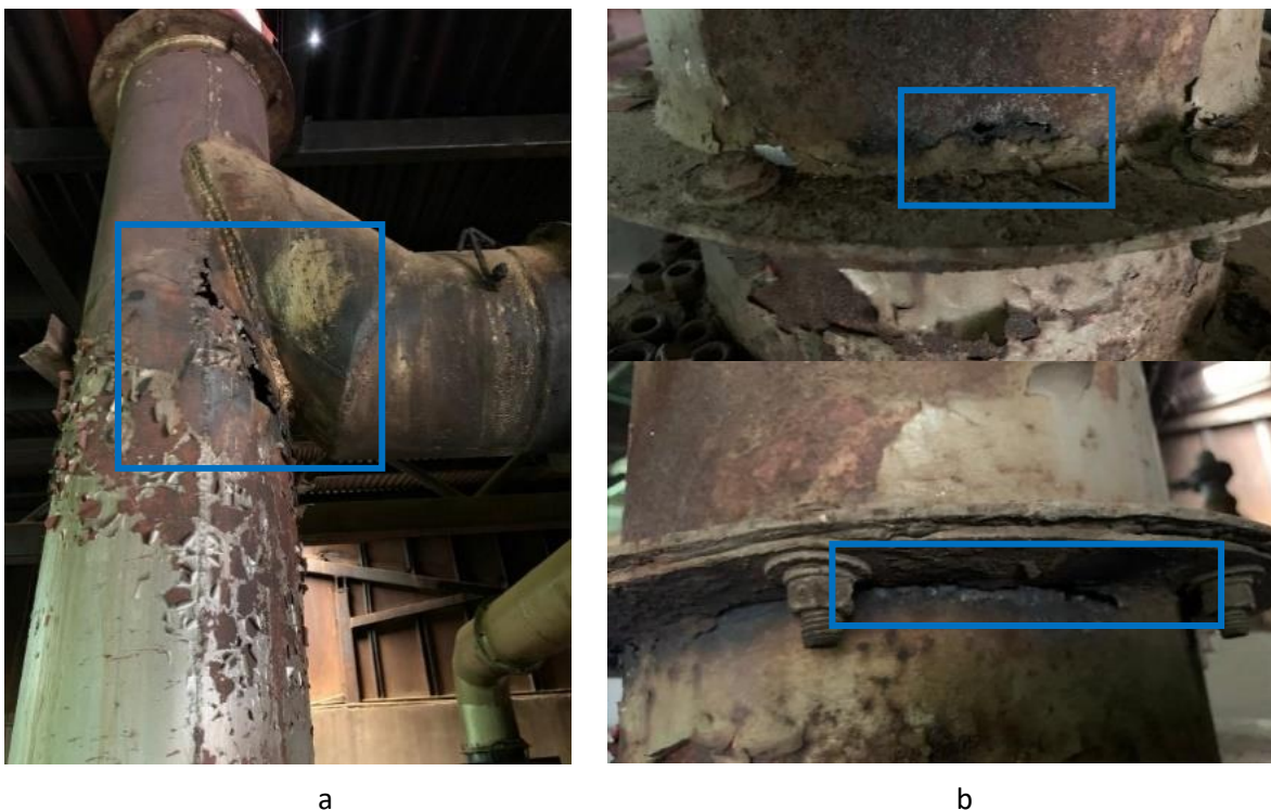
Figura 4.2. Daños en a) el distribuidor de gases y b) la base de la chimenea.
