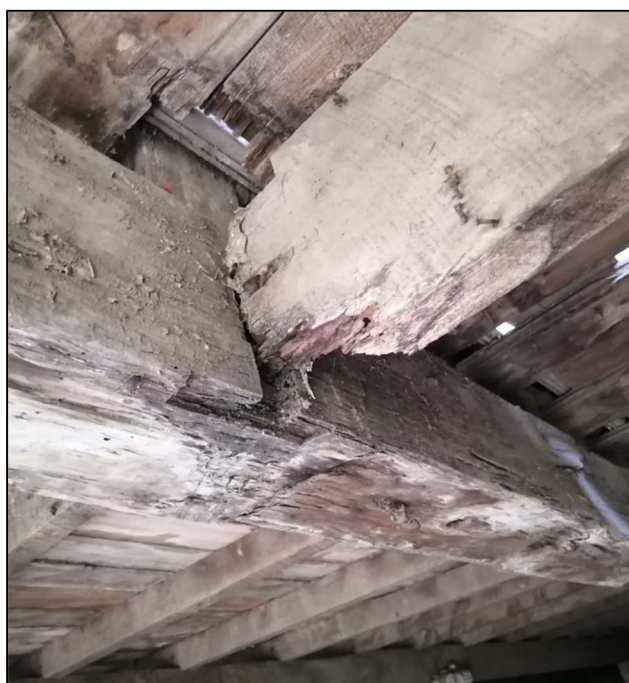
Figura 72. [d, 1-12] Conexión deteriorada, rebajo de esquina en vigueta y columna faltante
