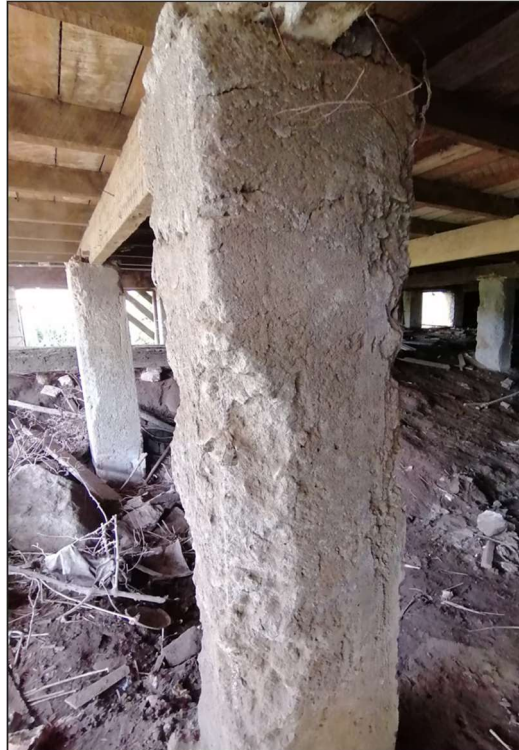
Figura 78. [cc, 6c] desgaste de concreto
