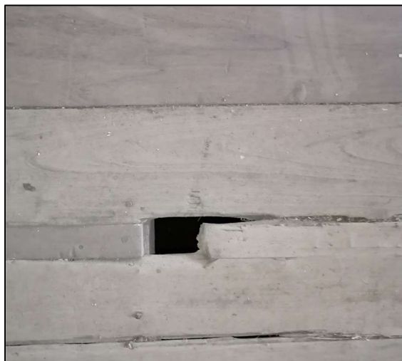
Figura 84. Agujero en piso del primer nivel
