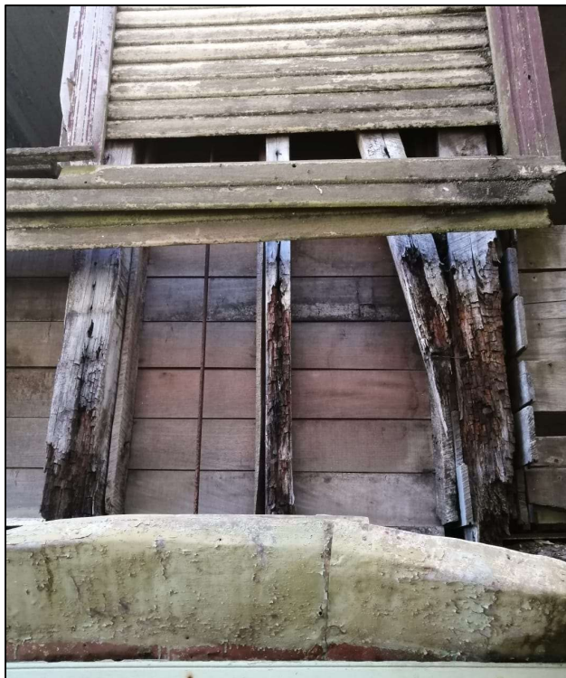
Figura 92. Pudrición en columnas y arriostres del segundo nivel fachada Oeste
