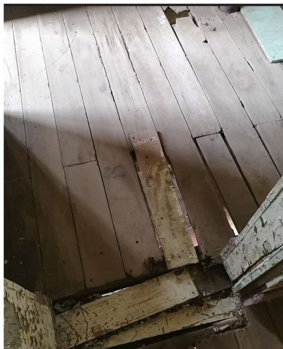
Figura 88. Tablas en mal estado en piso del primer nivel
