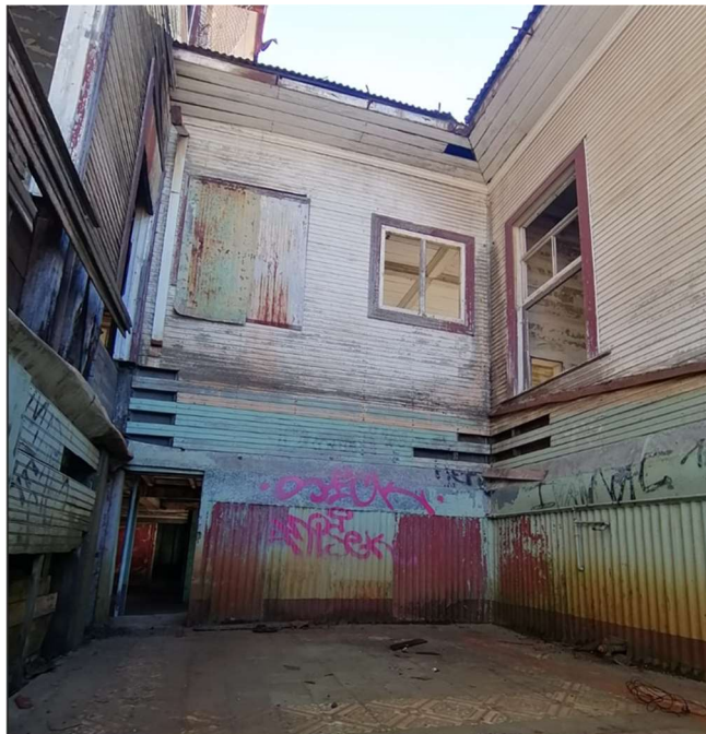
Figura 91. Fachada con acabados en mal estado
