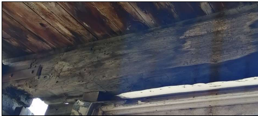
Figura 60. Viga [s, 1-12]: Cambios de volumen a lo largo de su longitud
