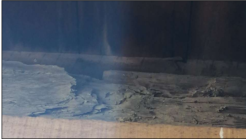
Figura 61. Viga [s, 1-12]: Resquebrajadura de la madera por humedad
