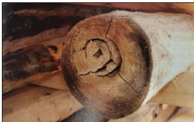
Figura 57. Muestra de defecto producido por ataque de termitas
