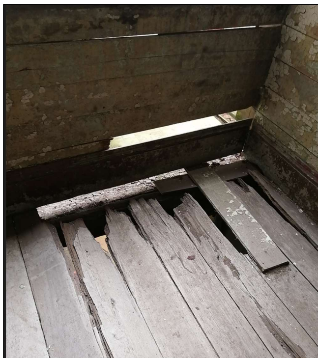
Figura 87. Tablas quebradas en piso del primer nivel
