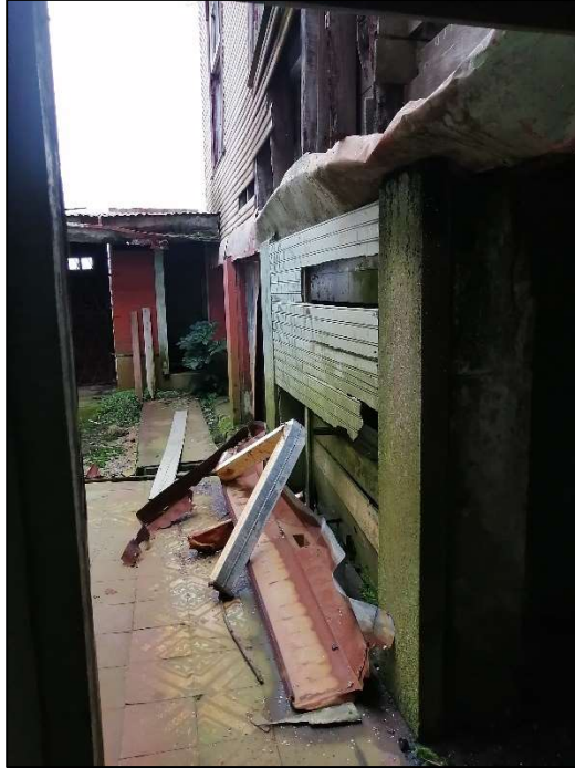
Figura 90. Acabados de las paredes dañados
