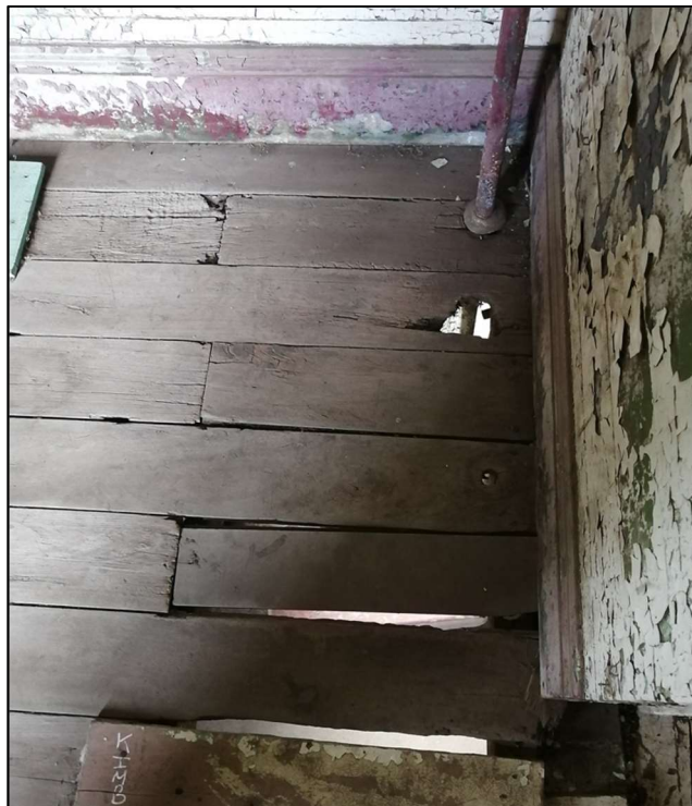
Figura 89. Agujeros en piso del primer nivel
