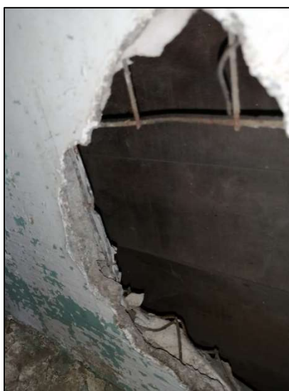
Figura 42. Muestra del ferrocemento encontrado
