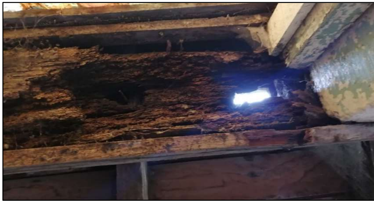
Figura 66. Viga [s-m,1]: pudrición por humedad
