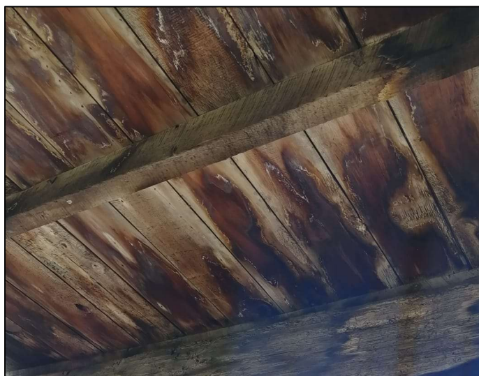
Figura 81. Entrepiso del sótano: efecto quemado por humedad
