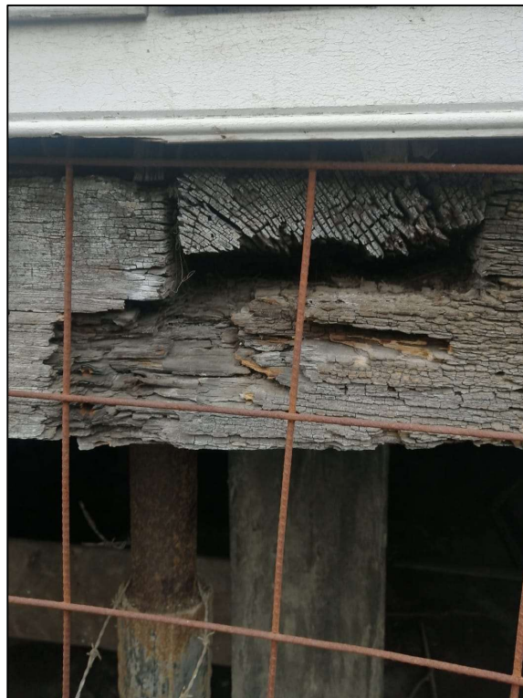
Figura 71. Viga [-a, 1]: pudrición por humedad
