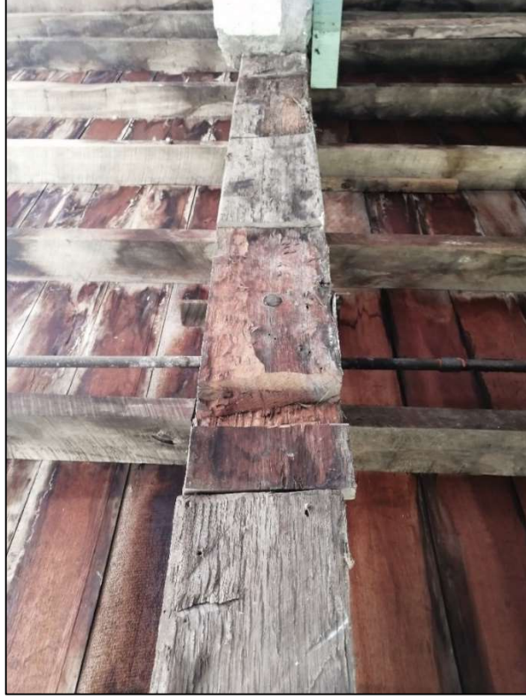
Figura 67. Viga [s-m,1]: reducción de volumen en longitud
