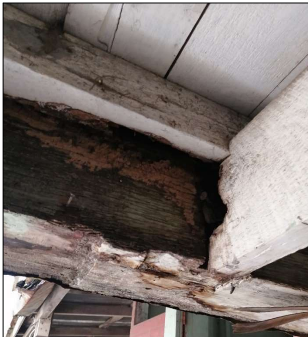
Figura 70. Viga [I, 1-12]: pudrición por humedad
