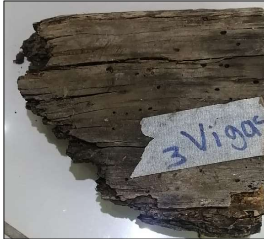
Figura 19. Muestra extraída de las vigas de madera
