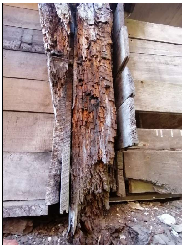
Figura 93. Pudrición en columnas del primer nivel fachada Oeste
