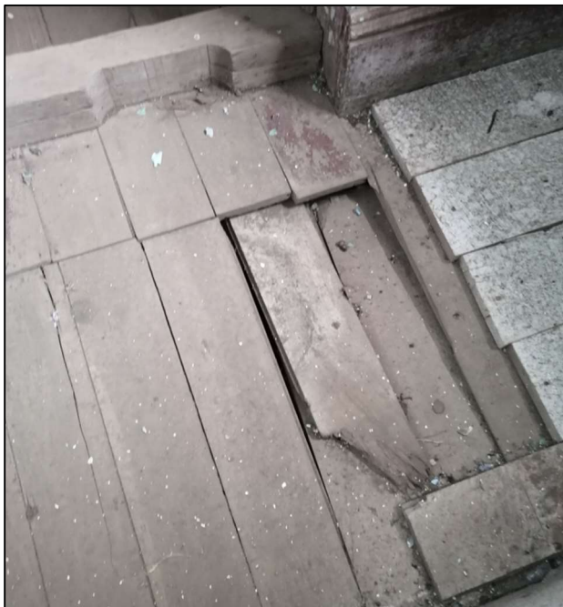
Figura 83. Piso hundido en primer nivel
