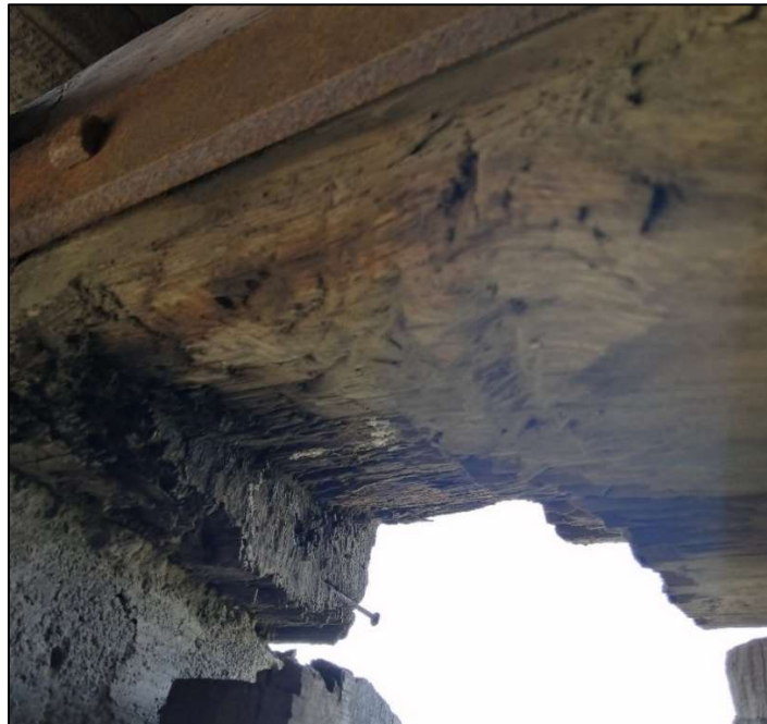
Figura 62. Viga [s, 1-12]: Rebajo de esquina
