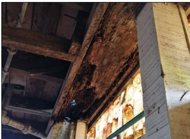
Figura 65. Viga [s-m,1]: pudrición por humedad
