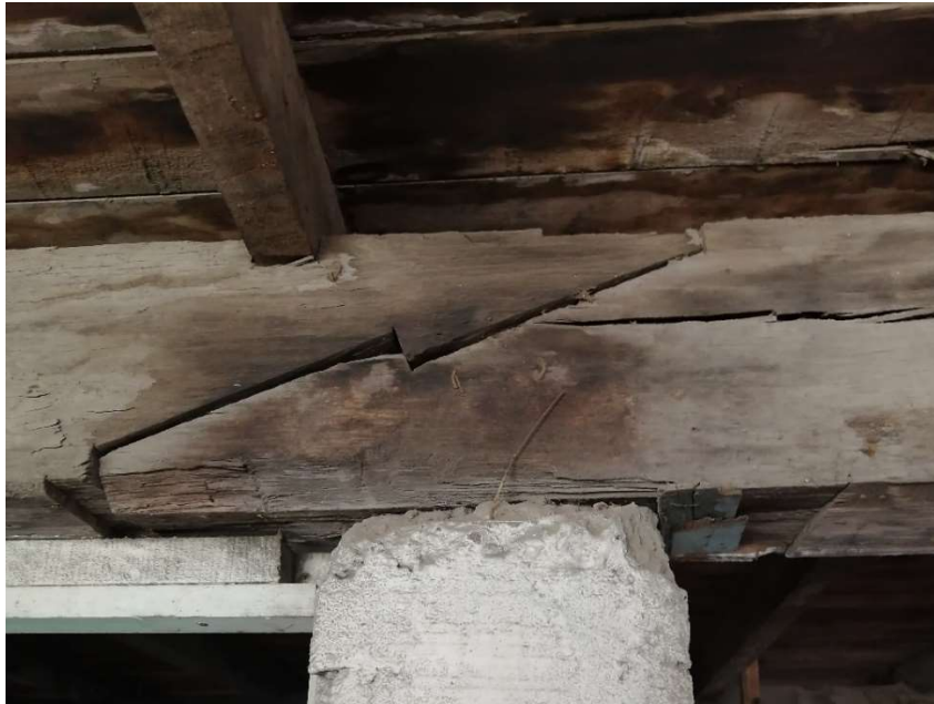
Figura 63. Viga [s-n,10]: conexión abierta y grieta longitudinal
