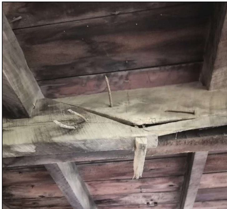
Figura 64. Viga [s-n,3]: conexión abierta y grieta longitudinal
