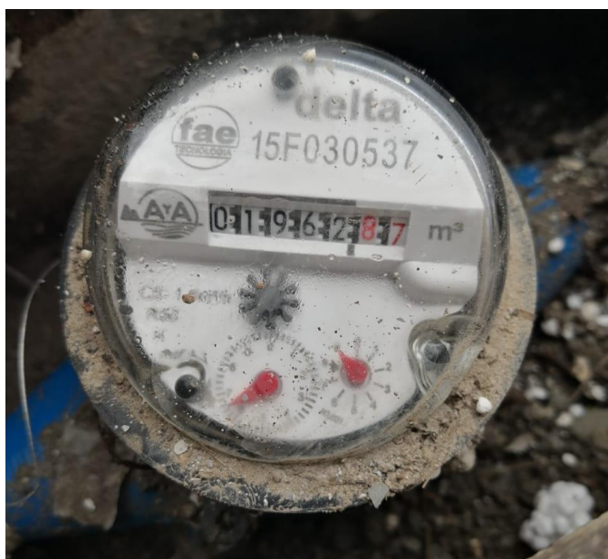
Figura 36. Medidor de agua del proyecto Torre Las Loras
