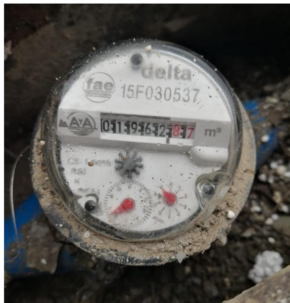
Figura 10. Fotografía del medidor de agua del AyA del proyecto Torre Las Loras
