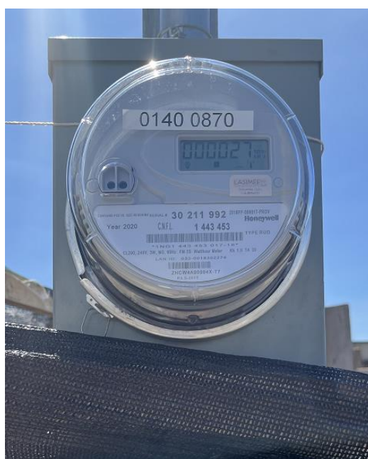
Figura 10. Medidor de energía en proyecto 2
