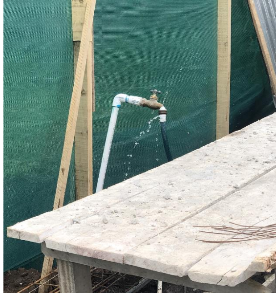
Figura 21. Desperdicio de agua en proyecto 1
