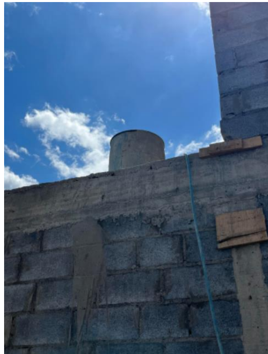
Figura 24. Estañón de recolección de agua nivel 2, proyecto 1
