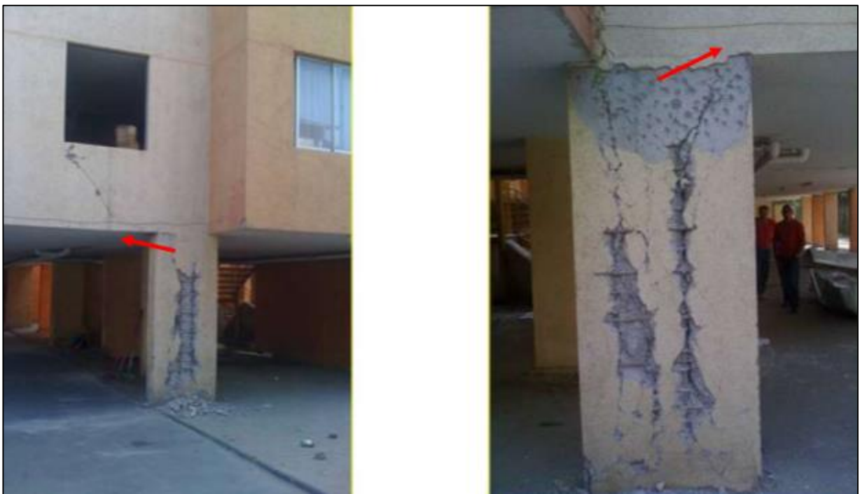
Figura 5. Losas de transferencia en el terremoto de Chile 2010
