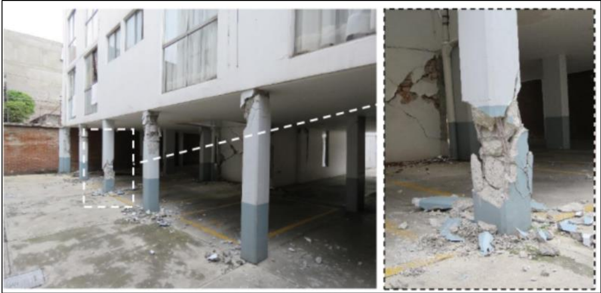
Figura 3. Falla de columna y falle en unión losa-columna en el terremoto de México, 2017
