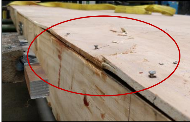
Figura 78. Falla en puntos de carga D2
