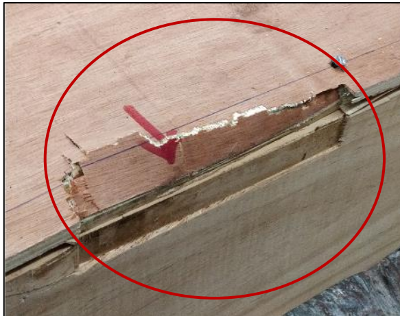
Figura 76. Aplastamiento en punto de carga
