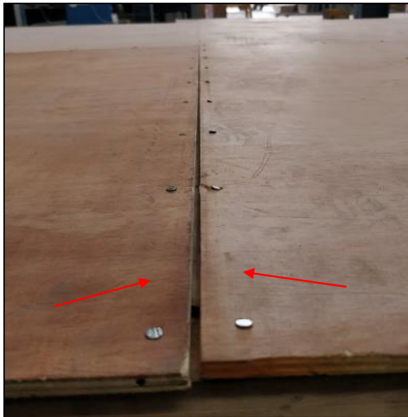
Figura 84. Deslizamiento de clavos y paneles
