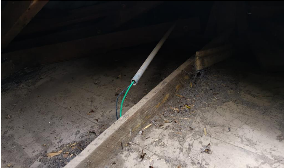
Figura 49. Detalle de salida a lámpara en cielorraso
