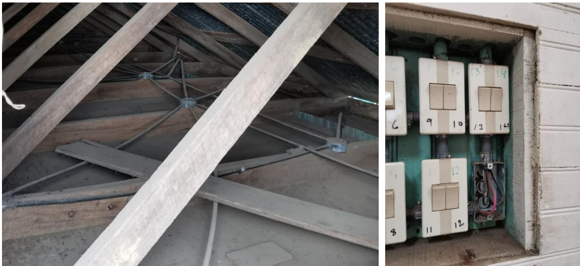
Figura 48. Instalación eléctrica actual
