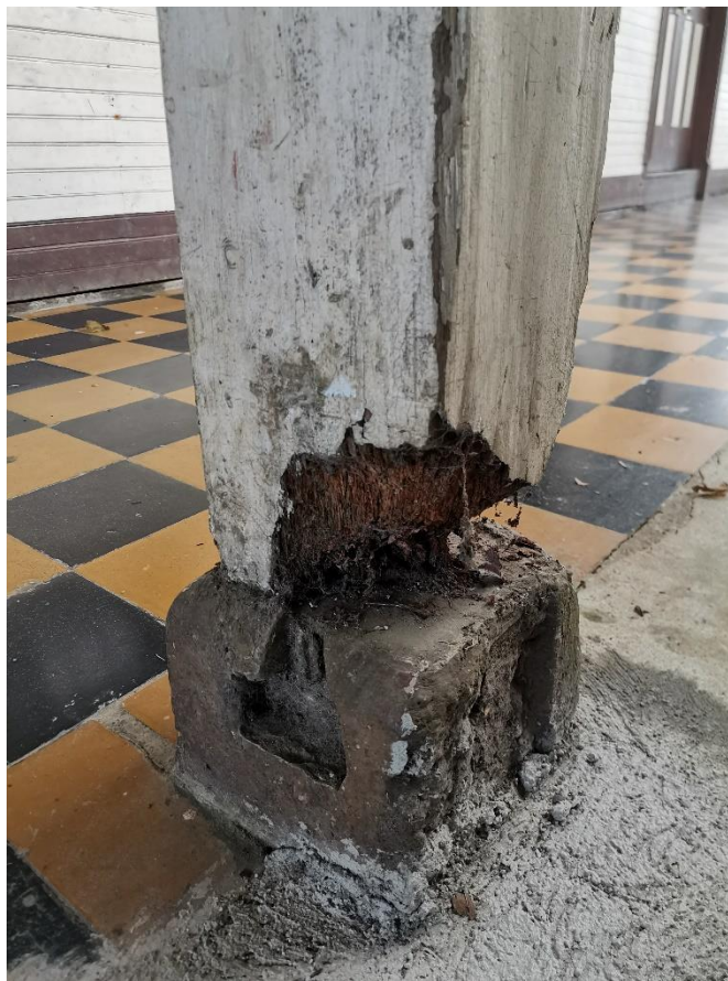
Figura 13. Base de columna deteriorada
