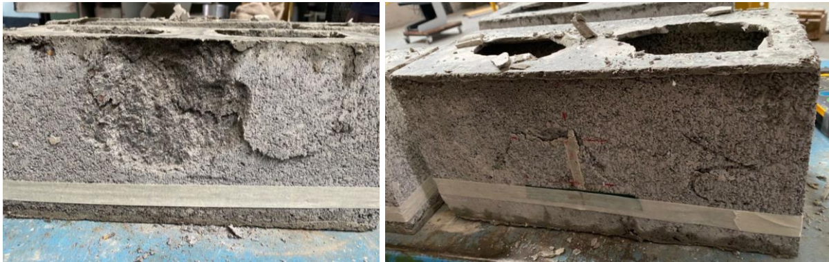
Figura 22. Falla presentada en los bloques de mampostería
