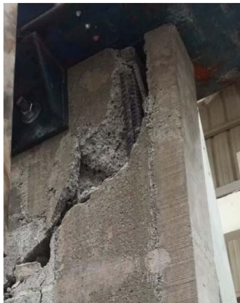
Figura 57. Estado final del nudo viga-columna
