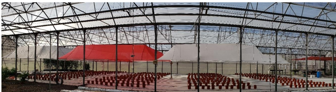
Figura 1. Mallas agrícolas tipo aluminizada, roja y perla respectivamente al 50 % de sombra, colocadas en forma de techo a 2,9 m de altura, en un ambiente protegido en la Estación Experimental Agrícola Fabio Baudrit Moreno, Alajuela, Costa Rica, 2020.
