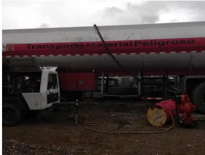
Figura 3.18. Sistema de bombeo hacia cisterna utilizando la bomba neumática Wilden.
