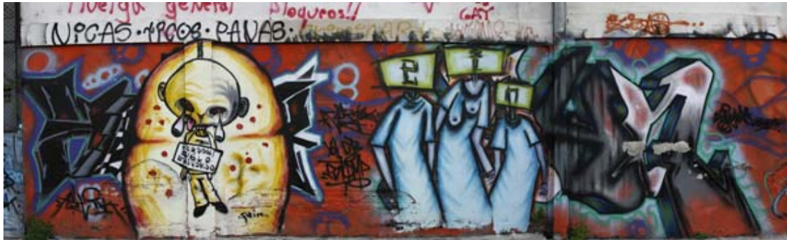
Fotografía N° 78 Predominio de graffiti en el Edificio Saprissa
