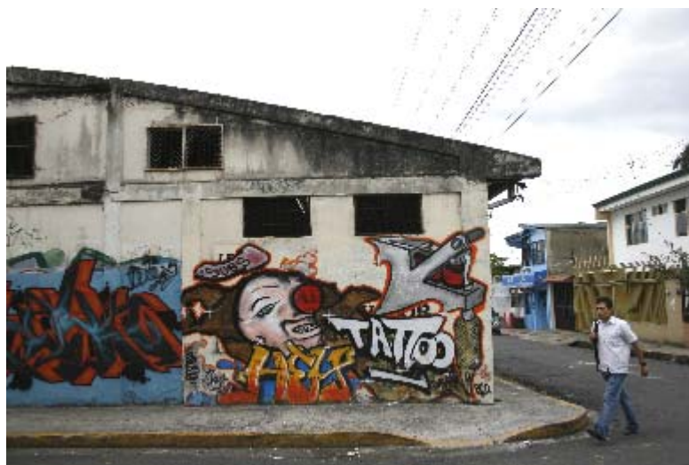
Paredes con graffiti Edificio Saprissa, 09/04/08 Foto: Marialina Villegas Zúñiga
