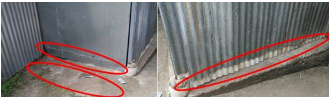
Figura 6. Sello metálico a nivel de piso de la bodega de sal.
