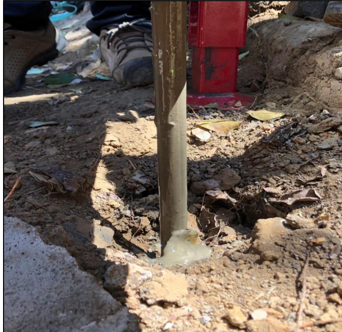
Figura 30. Perforación DPM-1 con salida de agua a 1,1 m de profundidad.
