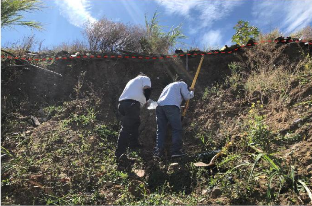
Figura 50. Deslizamiento rotacional sector Las Palmas.
