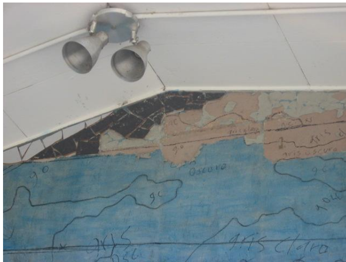
Figura 23. Repello desprendiéndose de la pared.
