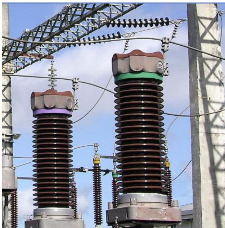
Figura 1.4 Transformadores de potencial
