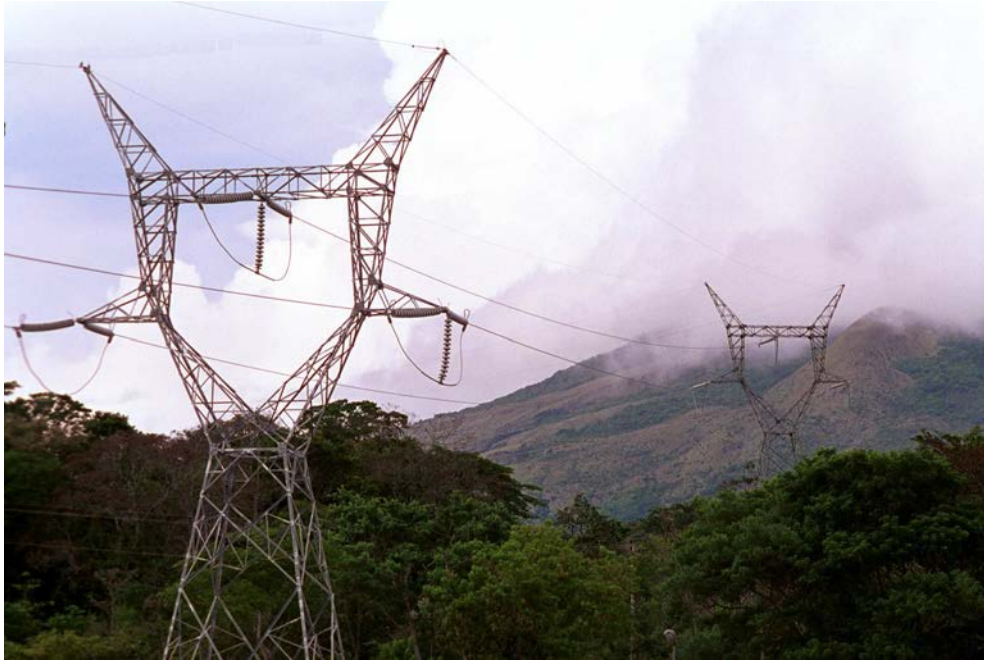
Torre de transmisión, tipo “cara de gato”, 230 KV
