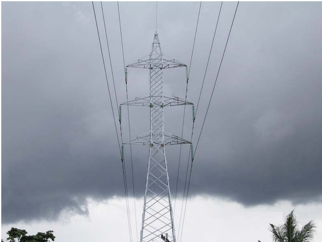
Torre de transmisión, doble circuito, un hilo guarda, 138 KV
