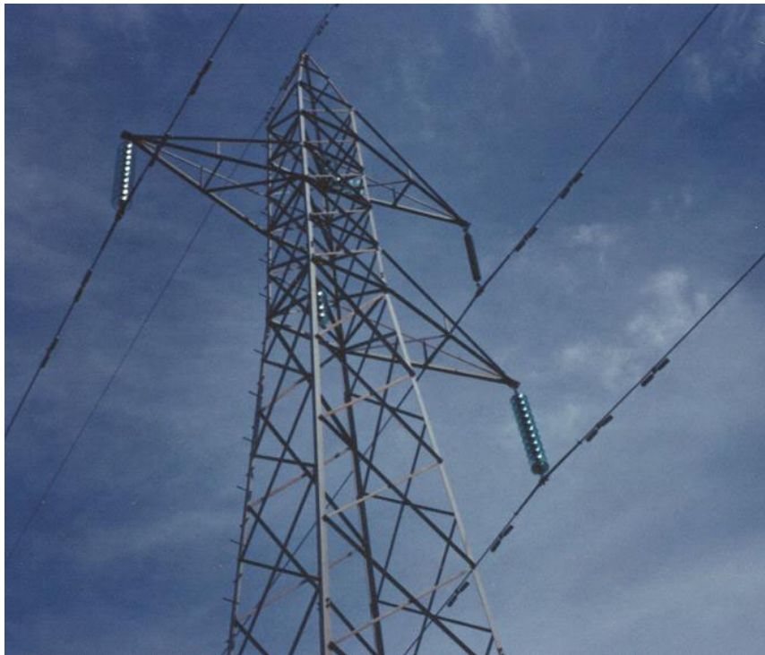
Torre de transmisión, un circuito en delta, 138 KV.
