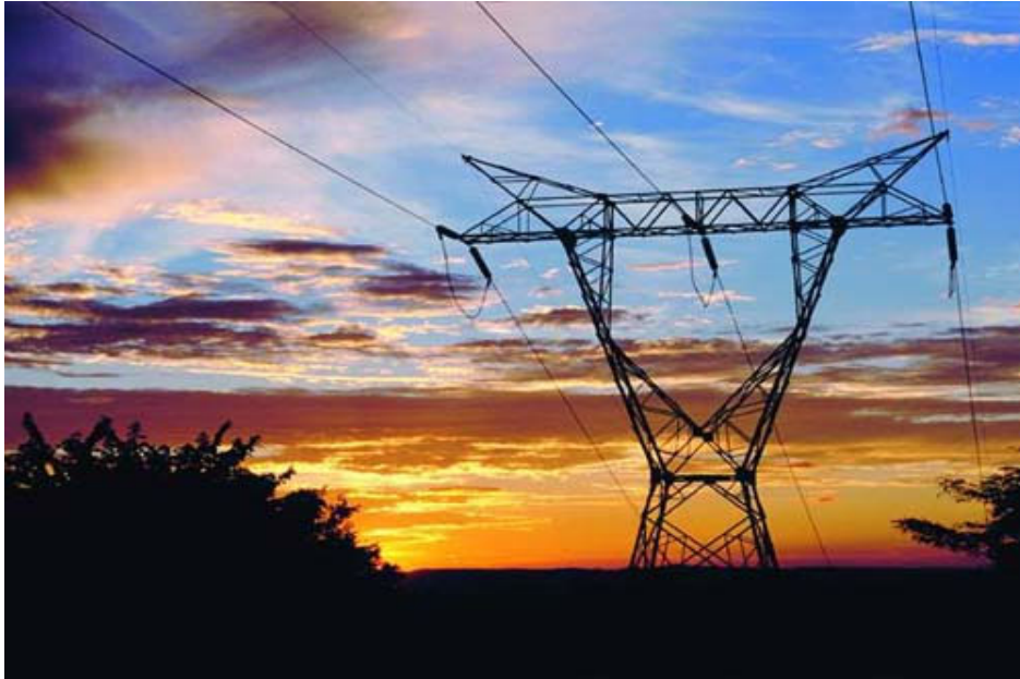
Torre de transmisión tipo plana, circuito horizontal, 230 KV
