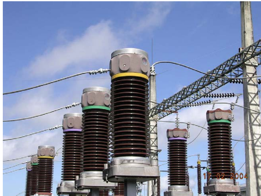
Figura 1.3 Transformadores de corriente
