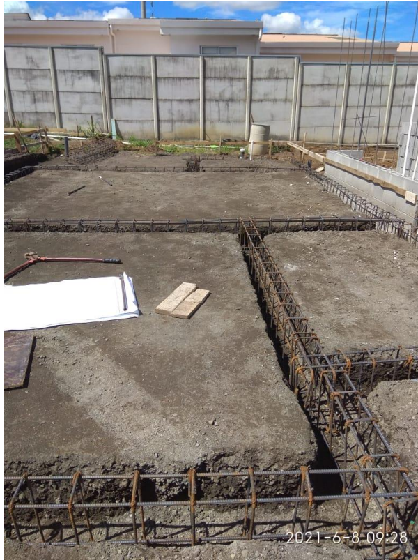
Figura 25. Imagen real de la etapa de colocación de acero de las cimentaciones
