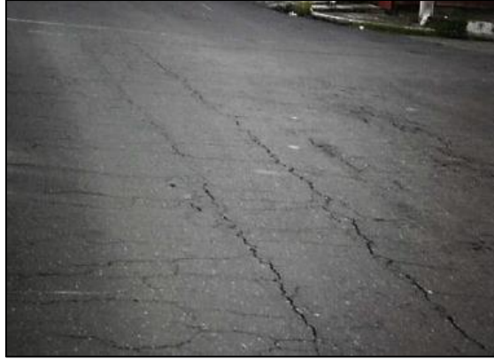
Figura 5. Grietas longitudinales en el pavimento a causa del DTC
