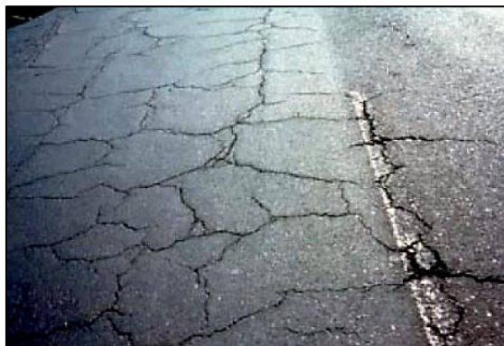
Figura 6. Grietas transversales a causa del TDC
